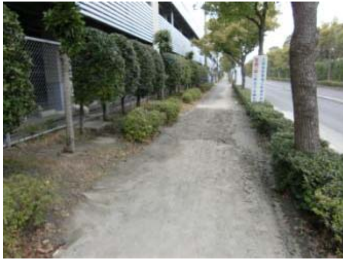
駐車場周辺の歩道には、多くの噴砂が残っていた。 歩道にクラックは入っていなかったが、植栽との間には 数cmの隙間が見られた。
