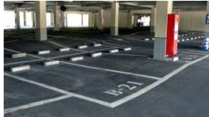
柱と柱との中心部において、5～10cm程度沈下している箇所が多数見られた。最大約25cm沈下している所もあり、段差が生じていた。
