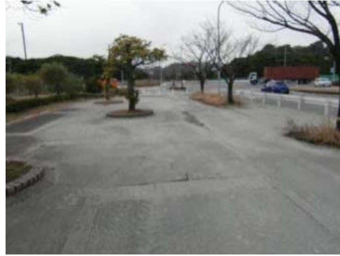
既に噴砂が片付けられた跡と思われる。 調査中も、路面や下水道の清掃と見られる作業が行われていた。
