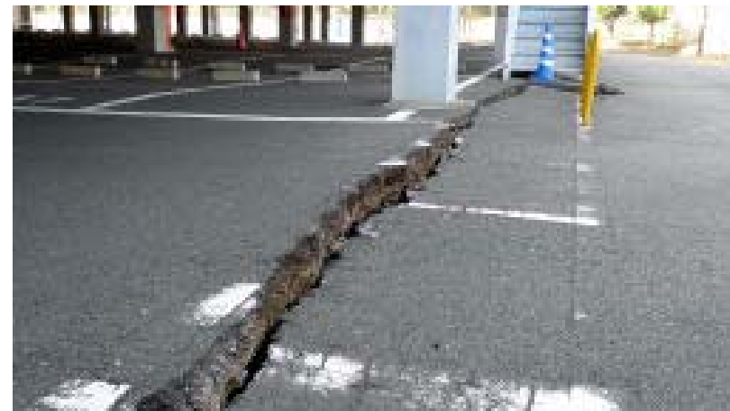
周辺地盤の沈下(およそ10cm)によるグラック
