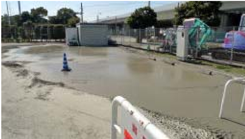
駐車場で最も噴砂(水)跡が広く残っていた。フェンスを介した歩道端には、舗装面との隙間が長く開いていたため、噴出した泥水が流れ込んできたことも考えられる。
