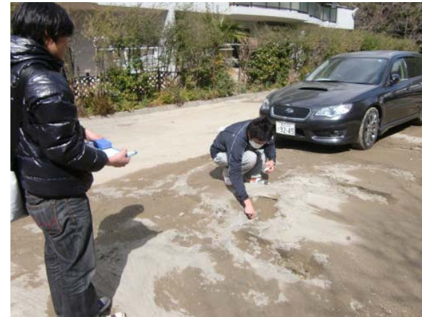
近くにあった駐車場では大量の噴砂が生じたことがわかる。 噴砂孔も残っている。
