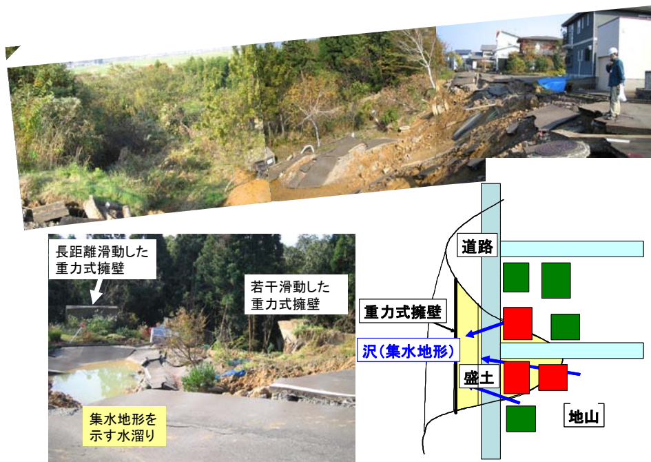
図-7b 2004年新潟県中越地震における高町団地での被害例
