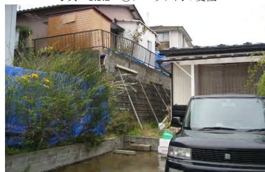
写真-3.3.3 ブロック塀の変位，下からは湧水
