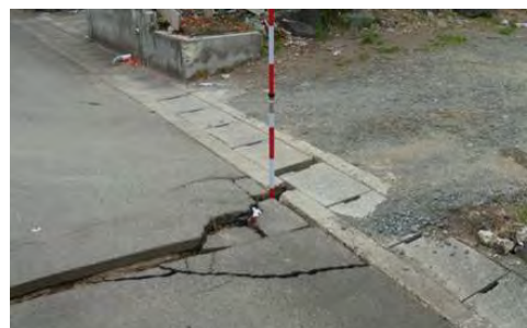
写真-3.6.1 宅地に認められる開口亀裂
