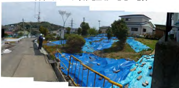
写真-3.2.2 公園内の亀裂
