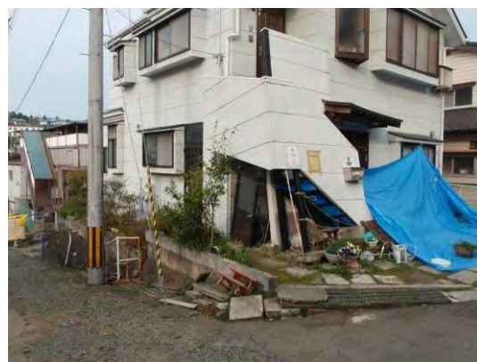
写真－3.4.3 斜面上端部の住宅被害
