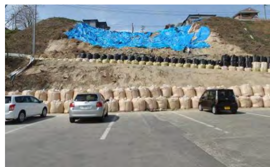
写真－3.14.1 進入路のり面の崩壊
