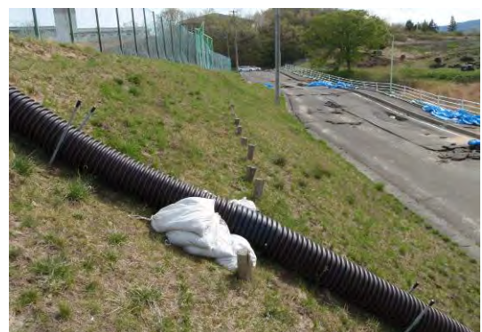
写真-3.16.5 盛土のり面の木杭打設跡
