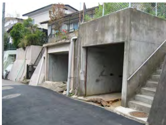
写真-3.3.7 ガレージ内の亀裂
