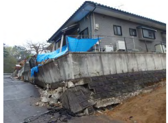
写真-3.9.9 下流部の家屋被害
