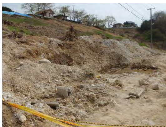
写真-3.13.5 崩壊箇所法尻の湧水状況
