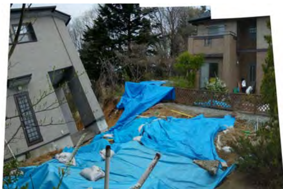
写真－3.11.3 崩壊家屋の状況
