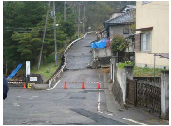
写真-3.9.8 下流部分での変状
