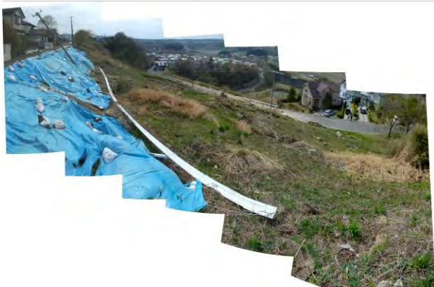
写真-3.13.1 崩壊箇所の状況(1)
