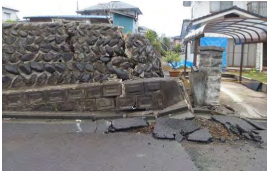
写真-3.9.4 境界部分での擁壁の破壊
