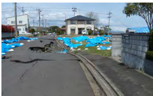
写真-3.14.4 進入路上部のり肩宅地の崩壊
