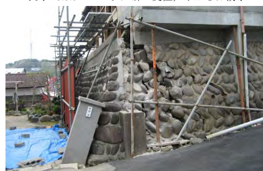
写真-3.3.4 玉石積擁壁の亀裂
