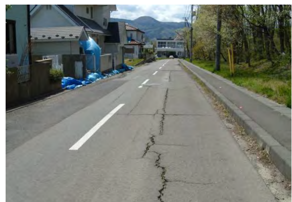
写真-3.15.6 路面のクラック状況
