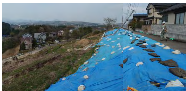
写真-3.13.2 崩壊箇所の状況(2)
