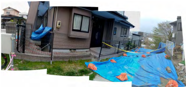
写真－3.8.4 宅地の被災状況(2)
