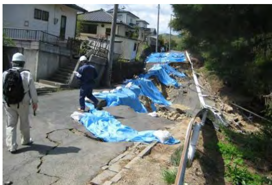
写真-3.14.5 北西進入路付近の崩壊
