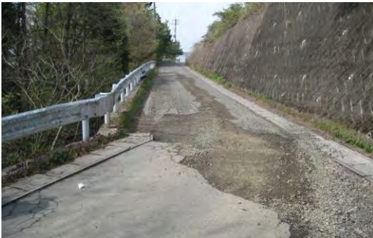
写真-3.12.5 道路舗装の被害
