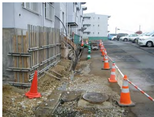
写真-3.10.3 駐車場の被害
