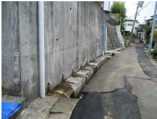
写真-3.3.6 斜面下の擁壁からの湧水
