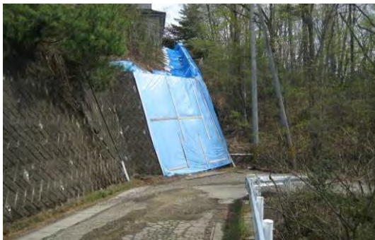
写真-3.12.4 ブロック積擁壁の被害
