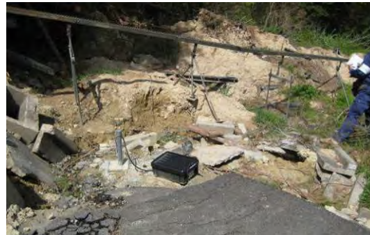
写真-3.14.9 崩壊堆積地でみられた湧水
