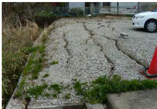
写真-3.7.1 斜面に面した空地のクラックの状況
