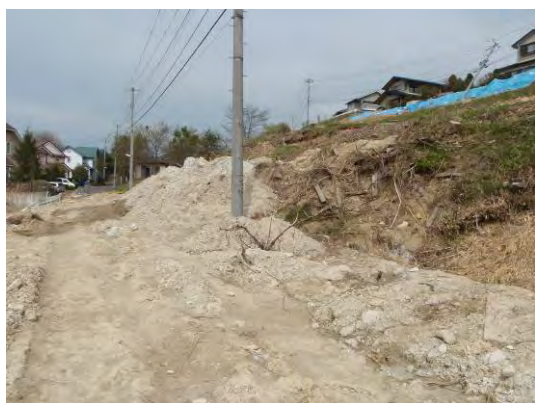
写真-3.13.3 崩壊箇所法尻の状況
