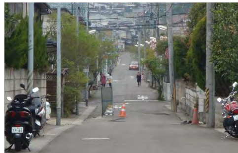
写真-3.5.6 擁壁より離れた位置の路面沈下
