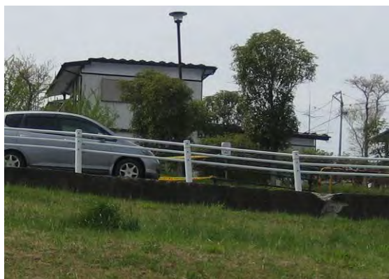
写真-3.2.7 4号緑地コンクリート擁壁に生じた亀裂
