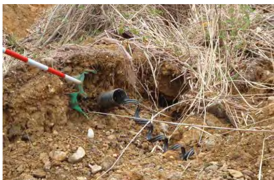
写真－3.11.2 有孔管暴露状況
