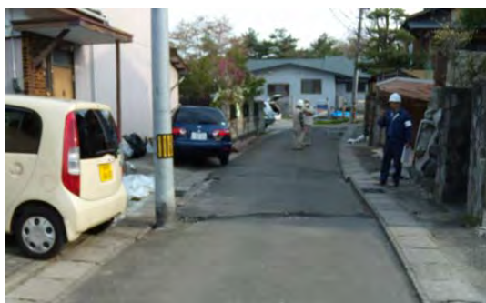
写真-3.7.2 道路に生じたクラックと左への移動状況
