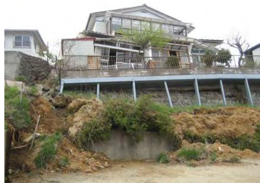
写真－3.4.5 斜面下端部での斜面崩壊
