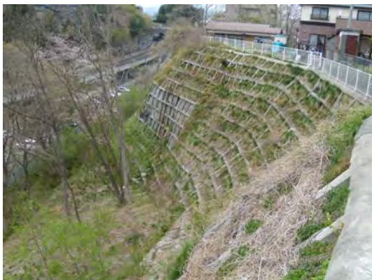
写真-3.6.4 真美沢急傾斜崩壊危険区域の対策済の隣接斜面
