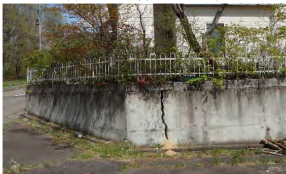
写真-3.15.5 宅地擁壁に生じたクラック
