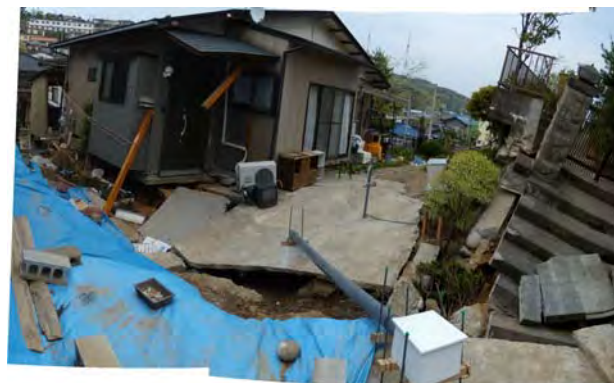
写真－3.4.4 斜面中央での崩壊
