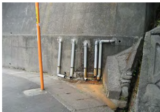
写真-3.1.13 2号緑地最下端部擁壁からの地下水排水状況
