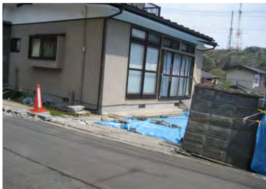
写真-3.2.1 3号緑地上端の宅地の亀裂
