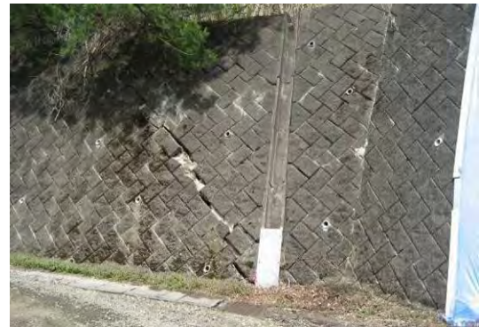
写真-3.12.7 ブロック積擁壁の亀裂
