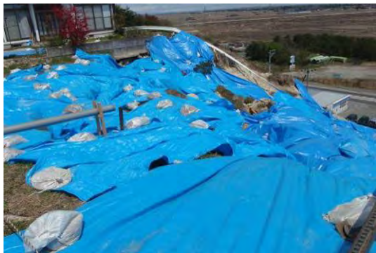
写真-3.14.2 進入路のり面上部の被害
