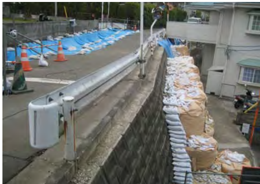
写真-3.5.3 ブロック積擁壁の変状状況
