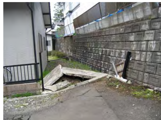
写真-3.3.8 コンクリート床板の座屈
