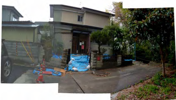
写真-3.6.2 1列目の人家の被災状況
