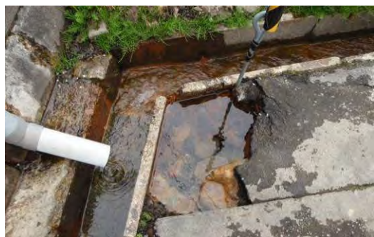
写真-3.4.7 斜面下端部における湧水
