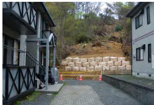
写真－3.11.5 法尻の崩壊土の状況
