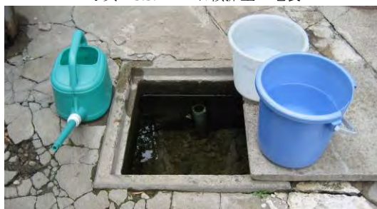
写真-3.3.5 ③ブロック斜面下の湧水
