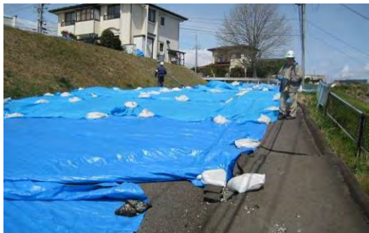
写真-3.14.3 進入路上部道路の亀裂
