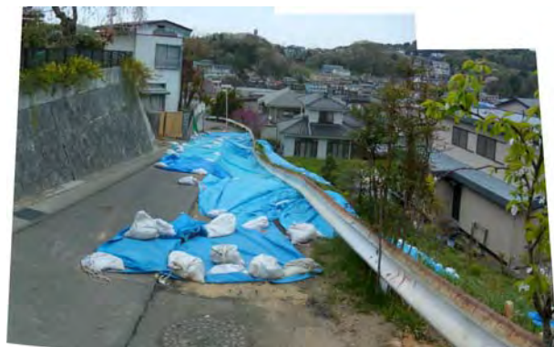
写真-3.3.1 ゴルフ練習場横の亀裂
