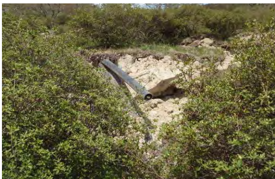
写真-3.15.3 有孔管暴露状況
