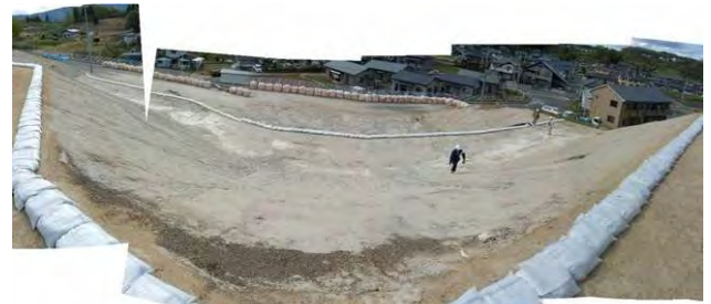
写真-3.16.4 変状を生じ排土された斜面 (連続写真)
