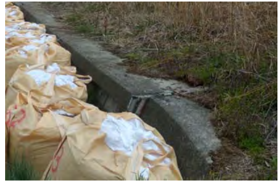
写真－3.8.6 法尻の井桁擁壁工の変状
