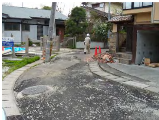
写真-3.7.3 道路および電柱の変状状況
