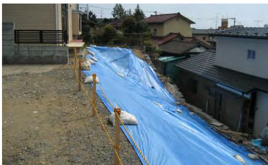
写真-3.1.12 1号緑地に隣接する崩壊
