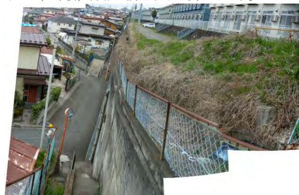
写真-3.5.1 変状箇所西側のコンクリート擁壁
