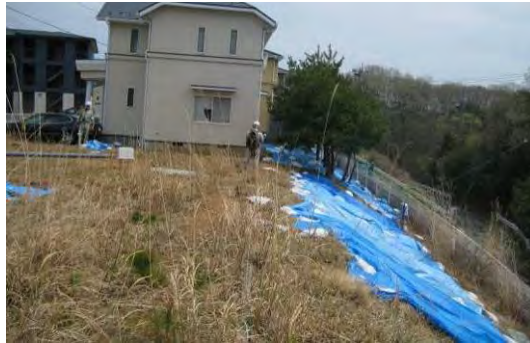
写真-3.12.2 のり肩部分の崩壊
