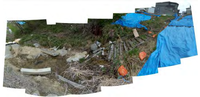
写真－3.8.7 地山との境界に設置された階段の変状
