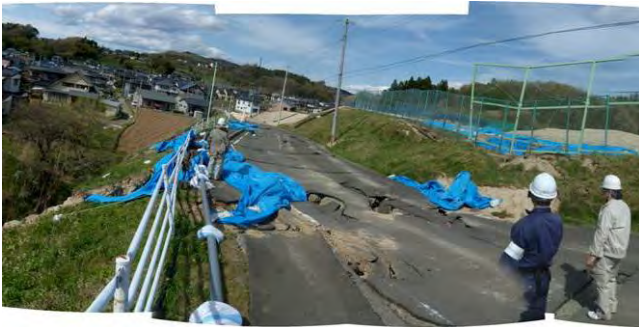
写真-3.16.1 道路の崩壊状況
