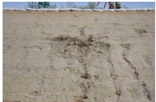
写真-3.16.5 切取りのり面の途中から発生したガリー
