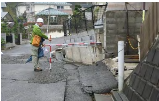
写真-3.9.7 左側へ移動したブロック
