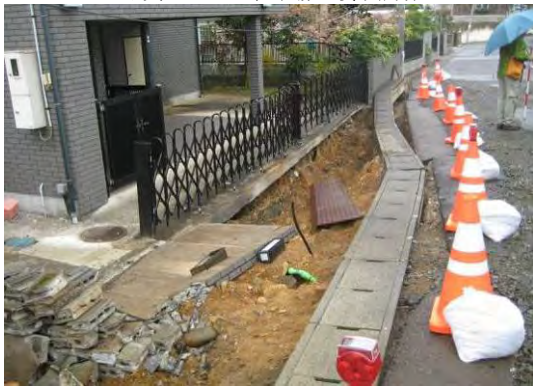
写真-3.9.6 ②ブロックでの亀裂
