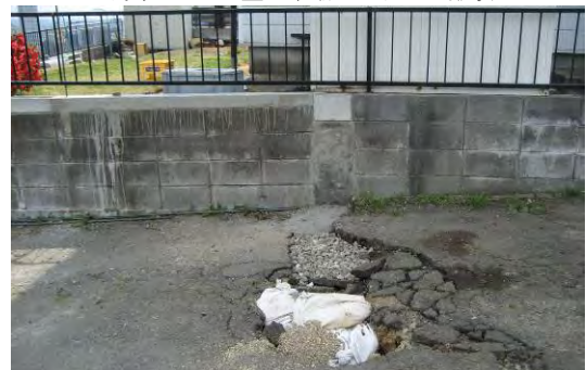
写真-3.2.6 3号緑地上端の亀裂
