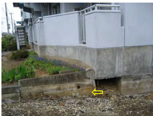
写真-3.10.1 住宅棟基礎部分の被害
