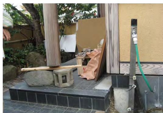
写真-3.7.4 木造家屋の変状状況
