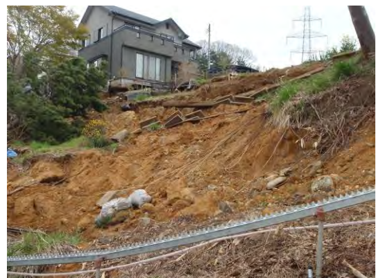
写真－3.11.1 崩壊状況と U 型トラフ
