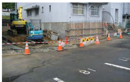
写真-3.10.2 B 地区の被害
