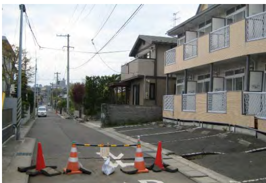
写真-3.5.5 亀裂上建物の変状状況
