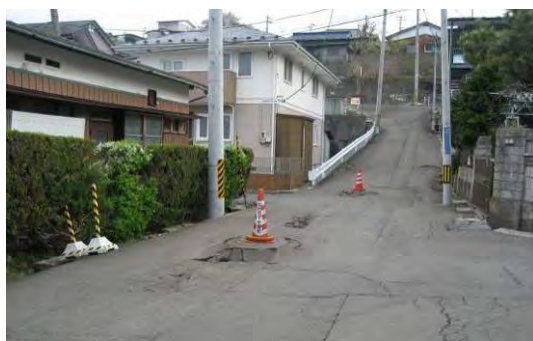
写真－3.4.1 マンホールの浮き上がり
