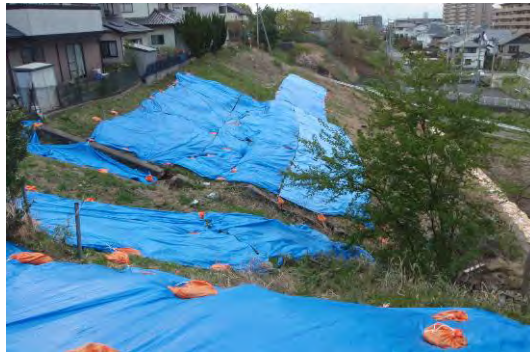
写真－3.8.2 上部からみたのり面の被災状況
