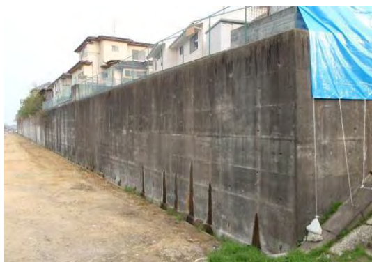
写真-3.4.6 L型擁壁からの湧水
