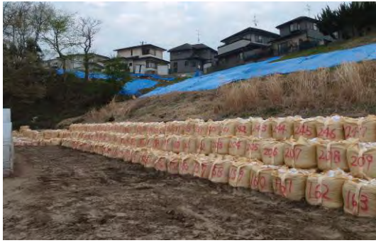
写真－3.8.1 下部からみたのり面の被災状況
