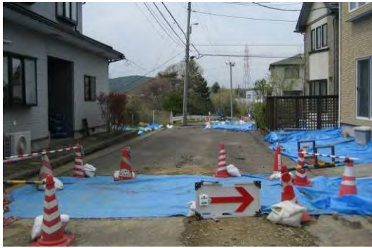
写真-3.12.1 宅地の被害
