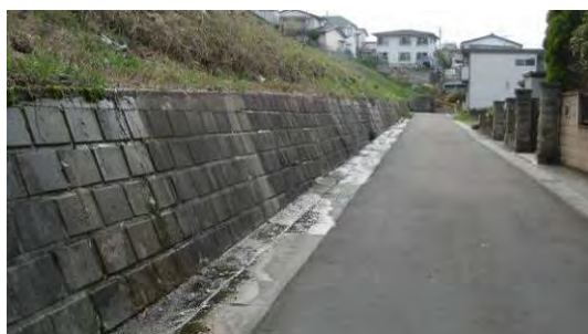
写真－3.4.2 ブロック積擁壁からの湧水
