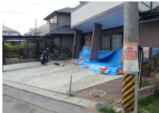
写真－3.8.3 宅地の被災状況(1)
