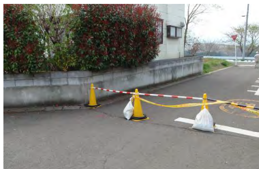
写真-3.13.4 斜面肩部の道路から2区画内側の路面状況
