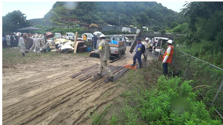
未舗装による泥濘状況
