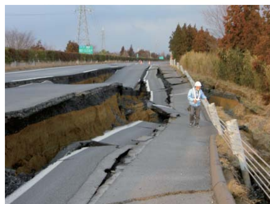
▲東北地方太平洋沖地震 常磐自動車道 那珂地区の盛土崩落 (提供：東日本高速道路株式会社)
