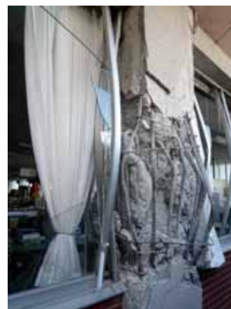
写真-6 須賀川市役所の 1 階 RC 柱せん断破壊
