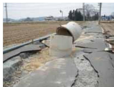
写真-4 マンホールの浮き上がり
