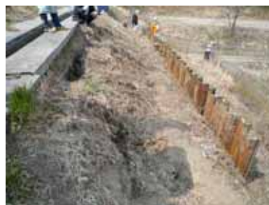
写真-3 盛土法面の亀裂
