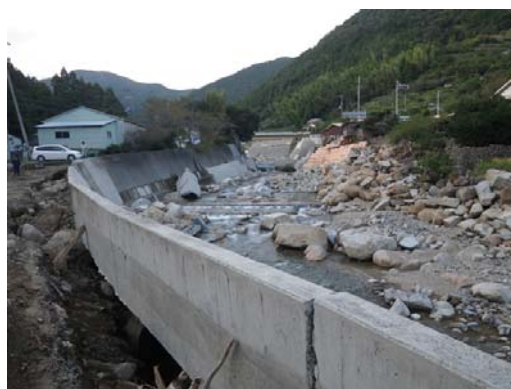
図-15 井戸川河川護岸の被害状況
