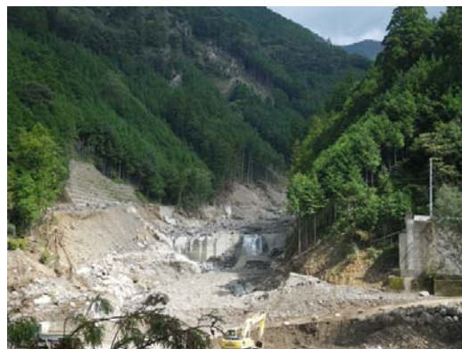
図-29 砂防堰堤の損傷状況
