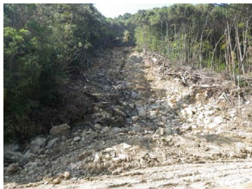
図-8 斜面崩壊の状況
