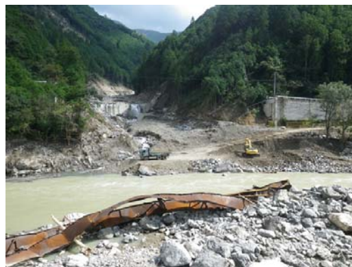
図-31 橋梁等の被災状況
