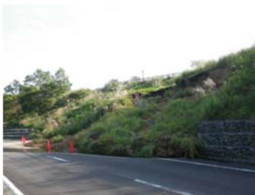
図-35 のり面の崩壊状況
