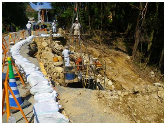
図-9 道路下端のり面の崩壊状況
