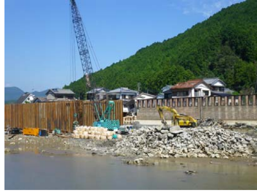
図-6 輪中堤の一部決壊状況
