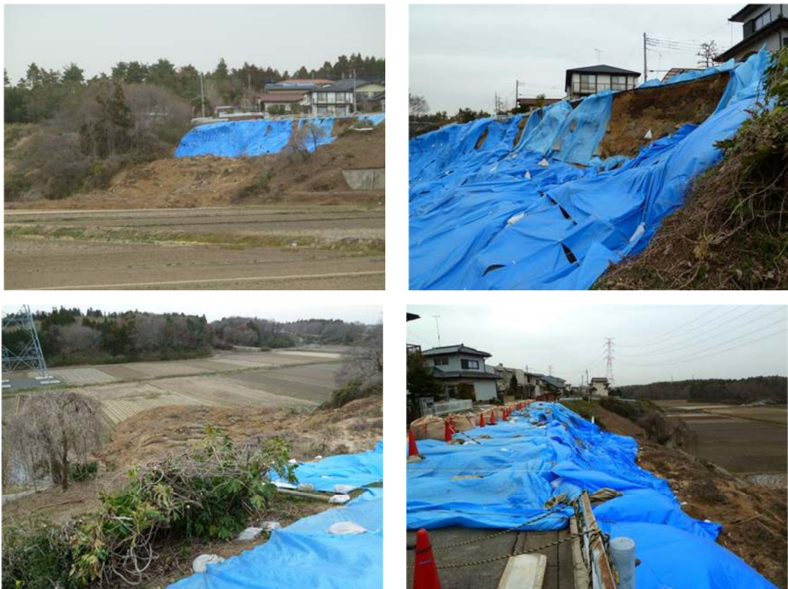
写真 3.1 盛土斜面の崩壊の崩壊状況
