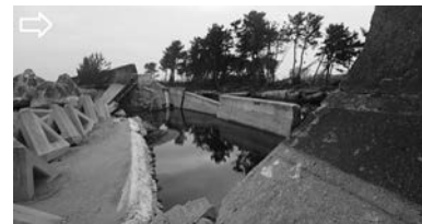
写真九 波返し構造の防潮堤の被害：荒浜④
