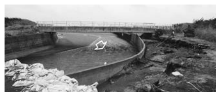
写真-28 河口からの越流での河川護岸の背面侵食：三川 E
