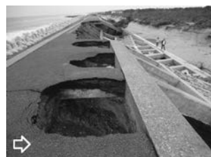
写真一13 裏法の侵食による天端の侵食：二の倉⑦
