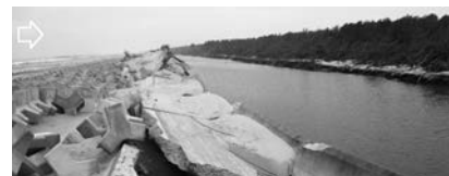
写真一22 裏法尻の侵食 (大規模) による落堀 : 吉田⑬
