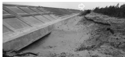
写真一16 防潮堤の裏法先の洗掘：荒浜①
