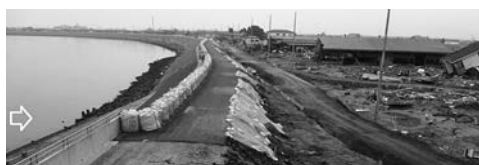
写真-23(a) 越流による河川堤防護岸の被害：阿武隈川右岸①
