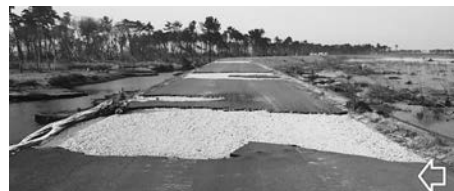
写真一12 堤防天端の舗装の剥離：井土浦⑤
