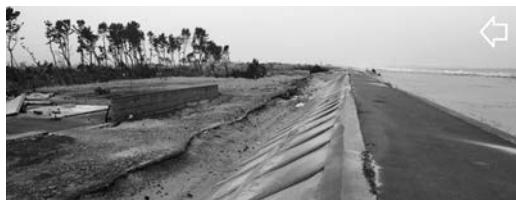
写真一18 裏法尻の侵食 (小規模) : 荒浜①
