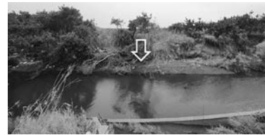
写真一32 河川護岸の背後からの津波による侵食：三川 E
