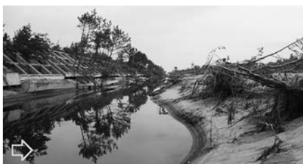
写真一20 裏法尻の侵食 (大規模) による落堀 : 寺島⑨
