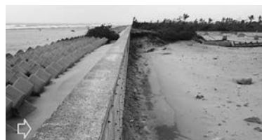
写真一15 直立防潮堤の背面の盛土の侵食：荒浜①
