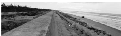
写真七 裏法が侵食（浅い）されても残る RC 直立堤：井土浜③
