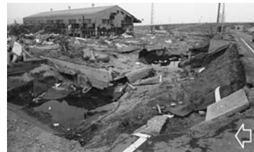
写真一31 越流による河川堤防の裏法の侵食と落堀の形成：阿武隈川右岸⑩
