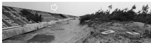
写真一17 ブロックが飛ばされた裏法：二の倉⑦
