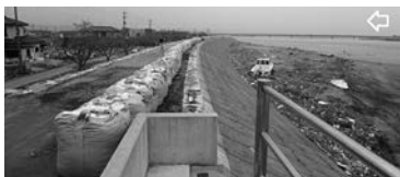
写真-23(b) 越流による河川堤防護岸の被害：阿武隈川右岸③
