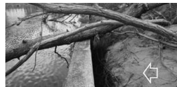
写真一34 貞山堀の矢板護岸の背後の侵食：井土浜③
