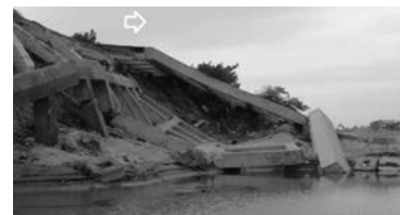
写真一21 裏法尻の侵食による格子枠の崩壊 : 北新田⑧
