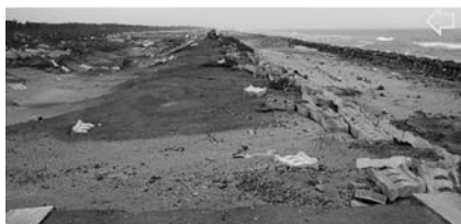
写真五 裏法の侵食による天端，ブロック張り防潮堤表法の崩壊：北新田⑧
