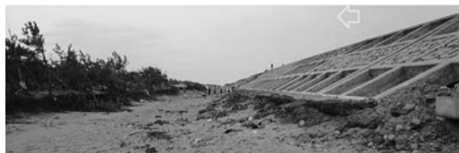
写真一19 裏法尻の侵食 (中規模) : 二の倉⑦
