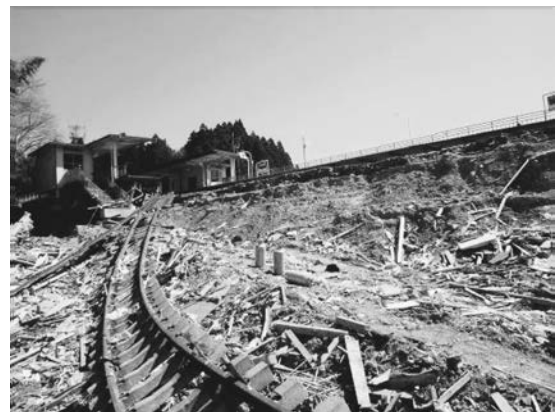
写真一〇 鉄道盛土の被災（南三陸町歌津，歌津駅）
