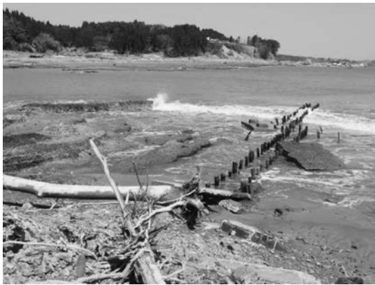
写真一七 赤崎海岸の砂浜流出と古い粘土質地盤の露出
