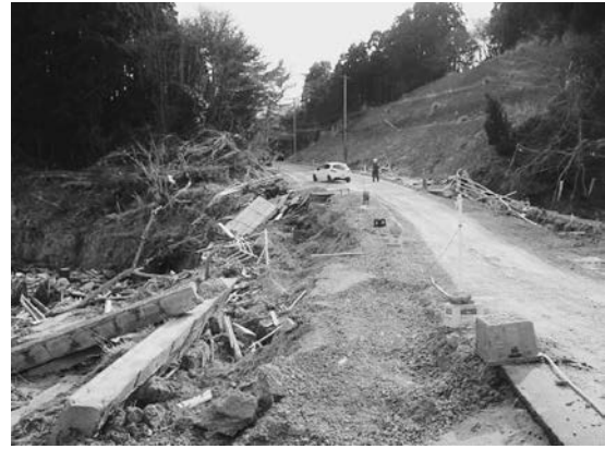
写真一八 道路盛土の津波被災（石巻市鮫浦，県道41号）
