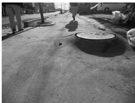
写真三 マンホールの浮上り（石巻市水明北、水明南）
