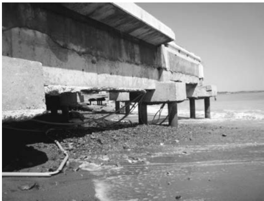
写真一六 赤崎海岸の砂浜流出による建物基礎の露出
