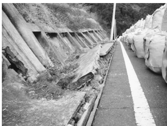
写真一13 切土法面の被害 (道路構造物の破壊, 石巻市侍浜, 県道2号)
