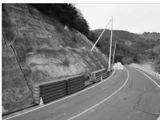
写真一12 切土法面の被害 (石巻市侍浜, 県道2号)
