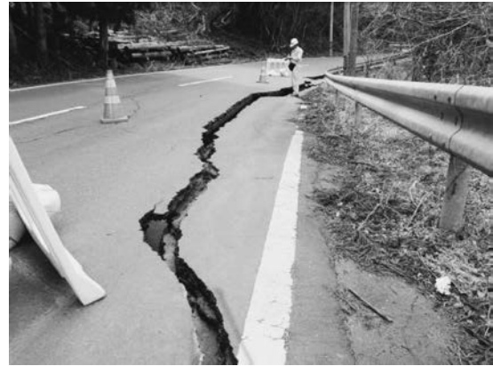
写真一九 谷部道路盛土変状（女川町高白浜，県道41号）
