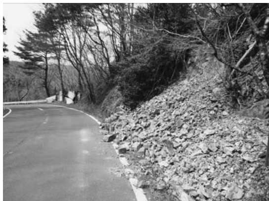
写真一11 切土法面の小崩壊 (女川町尾浦, 国道398号)
