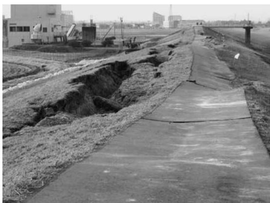
写真一 新江合川右岸堤防（2.8～3.0 KP 付近）の被害
