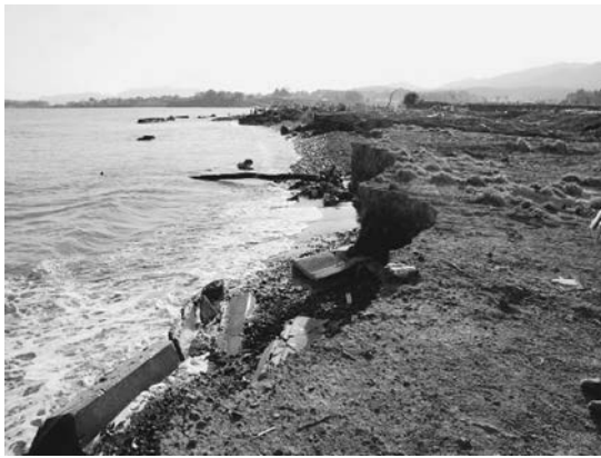
写真一5 御伊勢浜の海岸堤防損傷と砂浜流出
