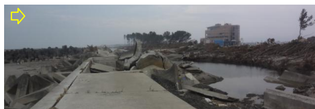
写真-10(a) 波返しと前面天端の組構造の防潮堤被害：荒浜⑭
