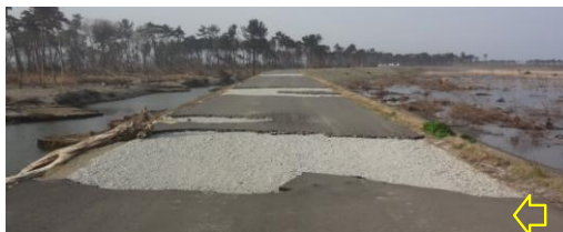
写真-12 堤防天端の舗装の剥離：井土浦⑤
