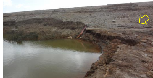
写真-86 裏のり先の落堀と裏のりの欠落：井土浦⑤
