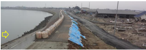
写真-23 (a) 越流による河川堤防護岸の被害：阿武隈川右岸⑪
