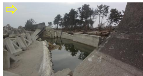
写真-9 波返し構造の防潮堤の被害：荒浜⑭
