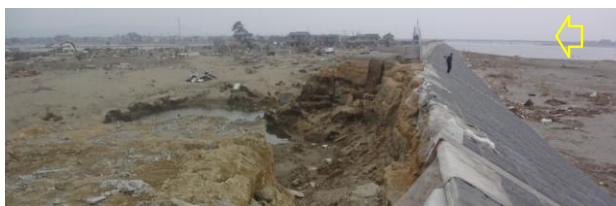
写真-6 裏のりの侵食による天端までの侵食：荒浜⑭
