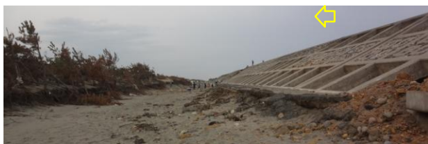
写真-19 裏のり尻の侵食（中規模）：二の倉⑦
