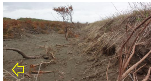
写真-53 裏のり尻での樹木の侵食：西足洗 D
