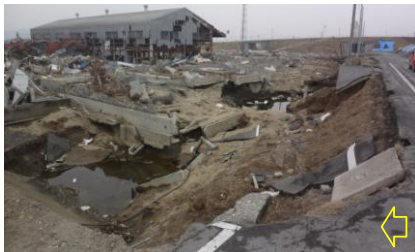
写真-31 越流による河川堤防の裏のりの侵食と落堀の形成：阿武隈川右岸⑩
