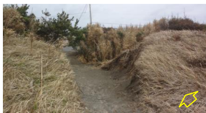
写真-89 写真-88 の盛土でのアクセス道の侵食：足川浜 B
