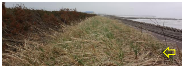
写真-77 津波（低越流）を受けた盛土天端：足川浜 B
