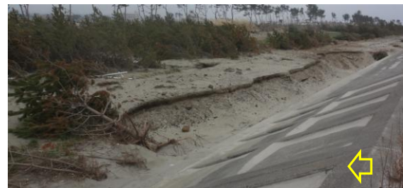
写真-52 裏のり尻で樹木の侵食：荒浜①
