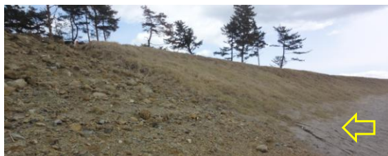
写真-73 侵食を受けた堤防の海側の表のり：井土浦⑤
