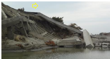
写真-21 裏のり尻の侵食による格子枠の崩壊：北新田⑧
