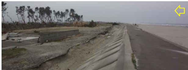
写真-18 裏のり尻の侵食（小規模）：荒浜①
