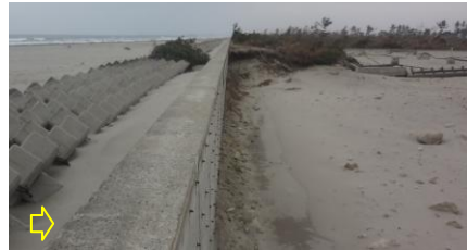
写真-15 直立防潮堤の背面の盛土の侵食：荒浜①
