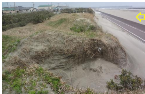
写真-75 津波を受けた盛土の表のり面の侵食：矢指ヶ浦 C
