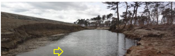
写真-79 裏のり尻の落堀の生成と裏のりの欠落：井土浦⑤
