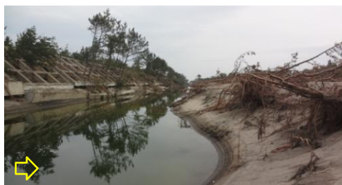
写真-20 裏のり尻の侵食（大規模）による落堀：寺島⑨
