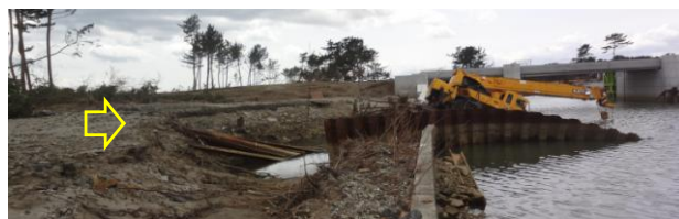
写真-40 写真-39の突き当たりの水門付近の被害：井土浜③
