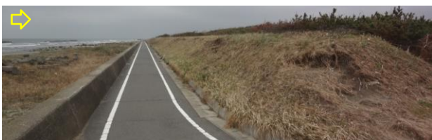
写真-74 津波（低越流）を受けた盛土の表のり面：三川 E
