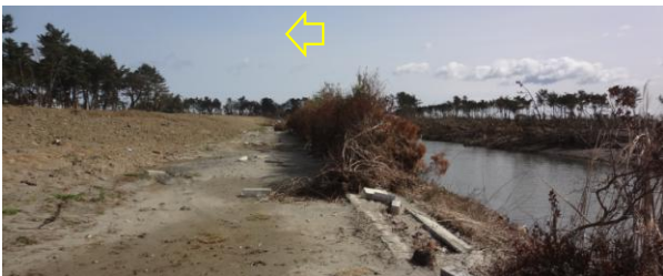
写真-85 新設堤防の表のりの張り芝の剥離：東浦④
