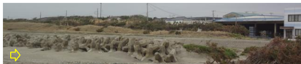
写真-88 高さの不揃いの盛土：足川浜 B
