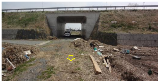
写真-94 浸水した仙台東部道路の山側：山元町山元 IC 付近
