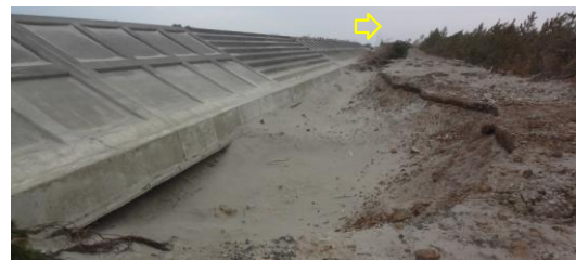
写真-16 防潮堤の裏のり先の洗掘：荒浜①
