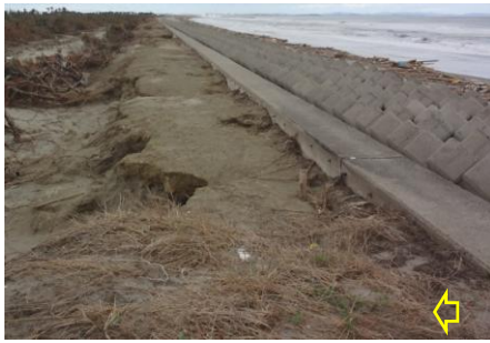
写真-102 防潮堤裏の草地（侵食）：井土浜③
