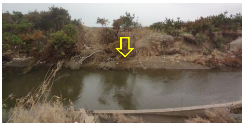
写真-32 河川護岸の背後からの津波による侵食：三川 E
