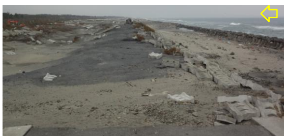
写真-5 裏のりの侵食による天端、ブロック張り防潮堤表のりの崩壊：北新田⑧
