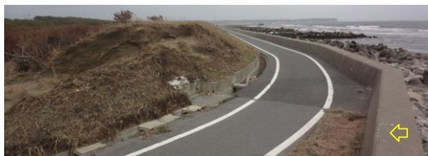
写真-90 河口で途切れた盛土の端部の侵食：西足洗 D
