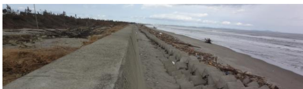
写真-7 裏のりが侵食（浅い）されても残る RC 直立堤：井土浜③
