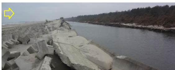
写真-22 裏のり尻の侵食（大規模）による落堀：吉田⑩
