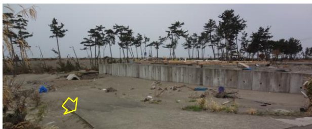
写真-45 保安林幅が狭い防潮堤背後の住宅被害：二の倉⑦
