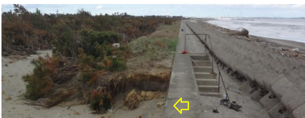
写真-14 直立防潮堤の背面に残った盛土：井土浜③
