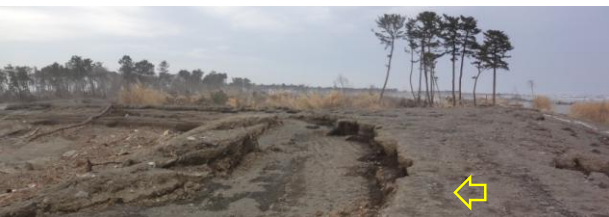
写真-84 新設堤防の天端と裏のり面の侵食：井土浦⑤
