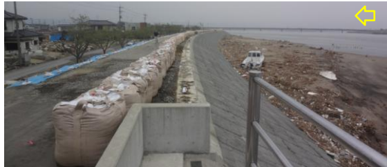
写真-23 (b) 越流による河川堤防護岸の被害：阿武隈川右岸⑪
