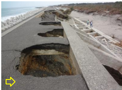
写真-13 裏のりの侵食による天端の侵食：二の倉⑦
