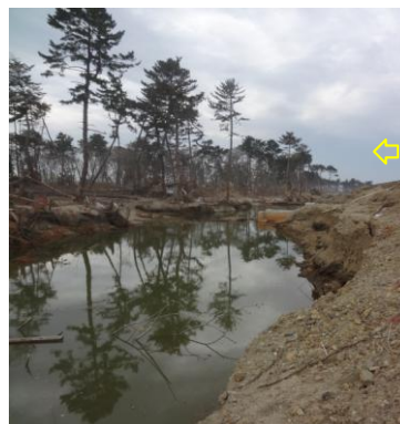
写真-65 堤防の裏のり尻に形成された落堀：井土浦⑤
