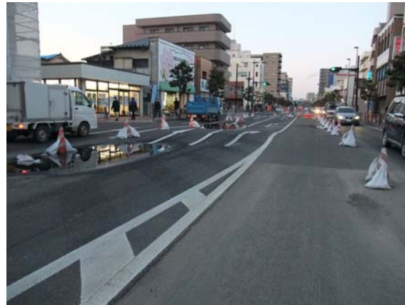
写真 2-5 仙台市太白区长町 3 丁目, 地下鉄上の道路の沈下
