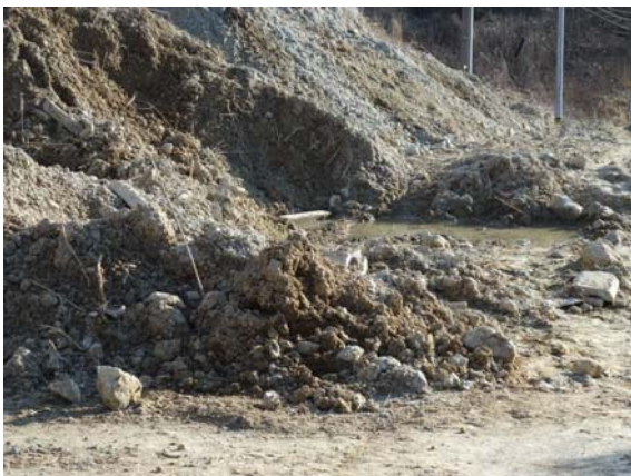
写真 2-4 北中山 3 丁目の崩壊土
