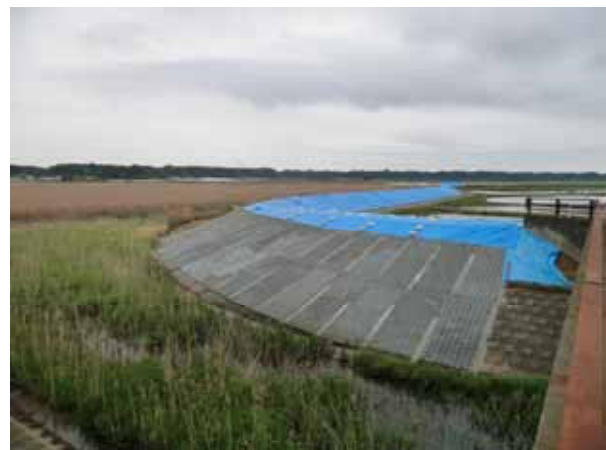
図5 堤防の被災と応急復旧状況 (ブルーシート+土のうで応急復旧)
