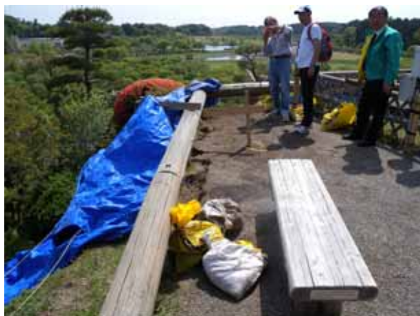
図10 偕楽園盛土斜面の損傷状況
