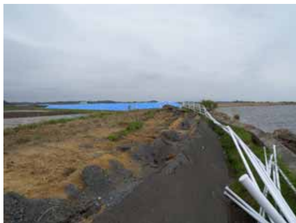
図6 堤防の被災状況(応急復旧措置なし、遠くに応急復旧箇所尾が見える)
