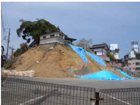
図9 水戸東照宮建立盛土斜面の崩落の状況
