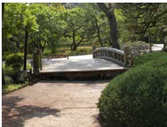
図11 偕楽園における地震後の地盤沈下
