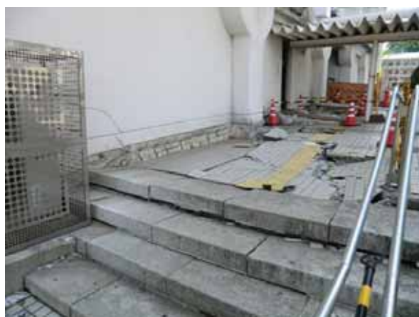
(b) 玄関の損傷
