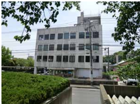
(a) 建物の傾斜
