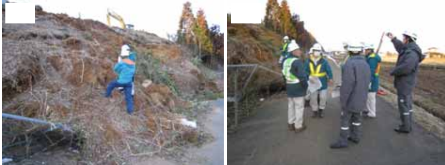
盛土のり尻部のフェンスが崩壊により変形
