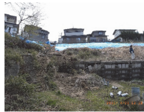
写真-1 地震発生直後の被害状況（のり面および擁壁の崩壊）
