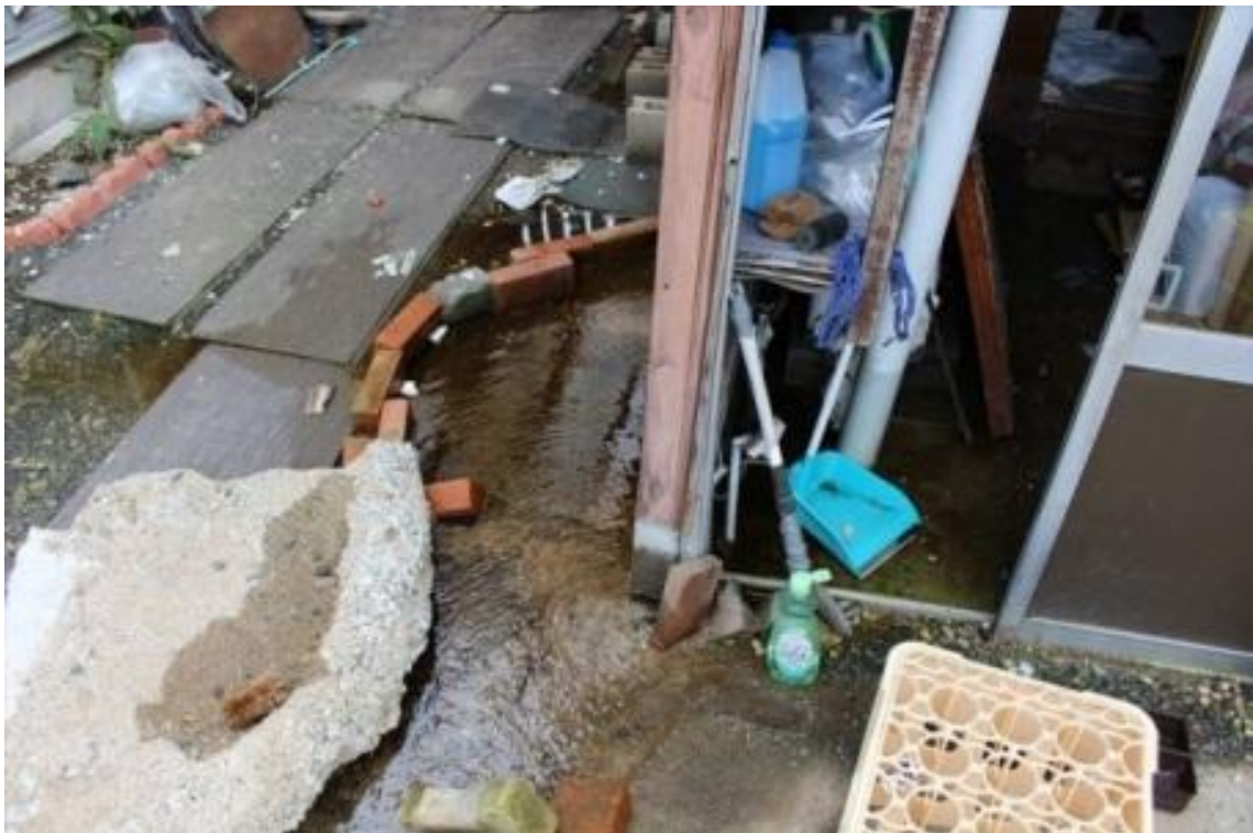
口絵写真-15 地下水管損傷による湧水
