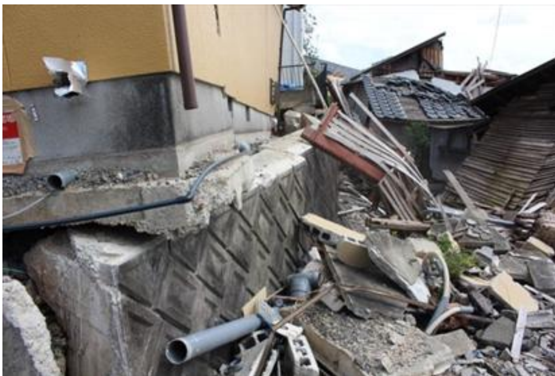
口絵写真-13 擁壁の倒壊に伴う地盤変状
