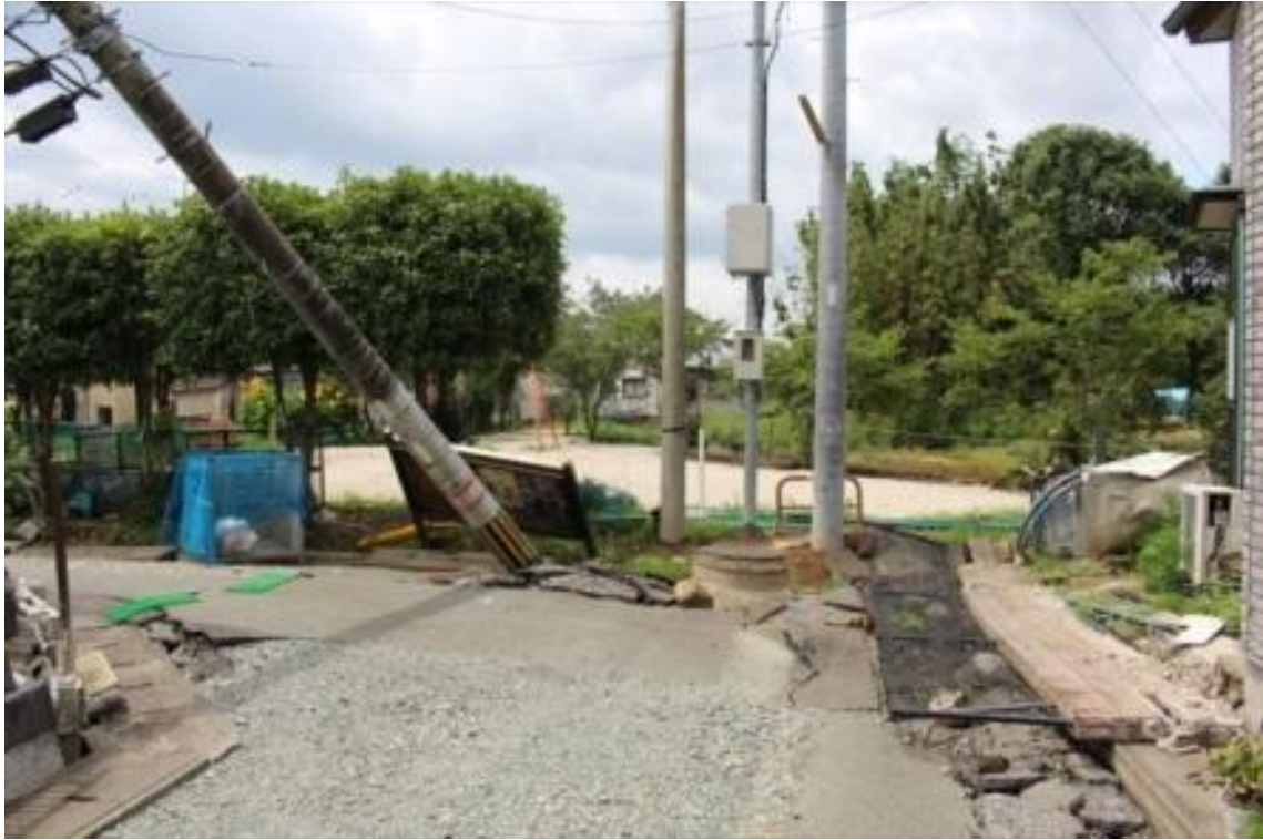
口絵写真-14 電柱の傾きとマンホールの浮き上がり
