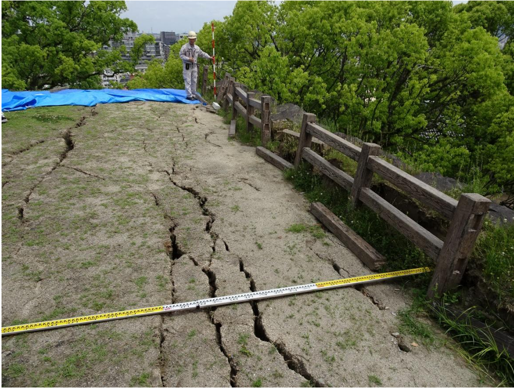
口絵写真-23 長局櫓北側のクラック発生状況
