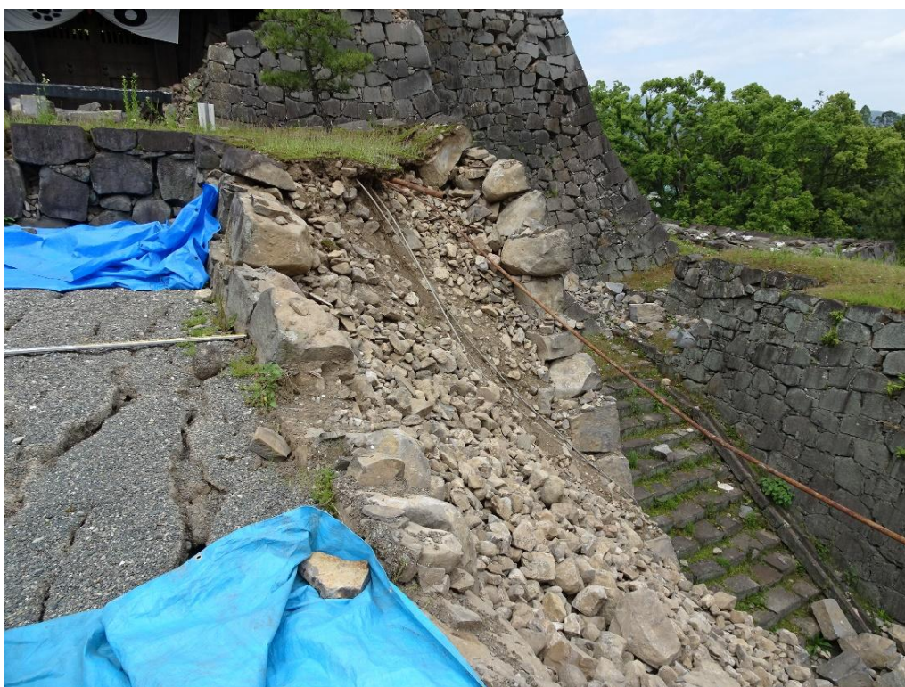
口絵写真-21 天守北側石垣の崩壊とクラック発生状況
