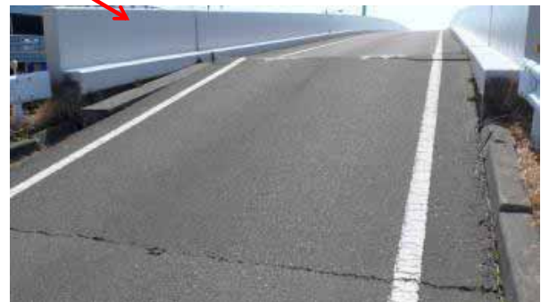
盛土と橋脚の境界部分にあたる路面の状態。
