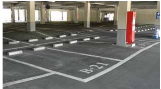
30分後の地震で床盤が一斉に沈下した
