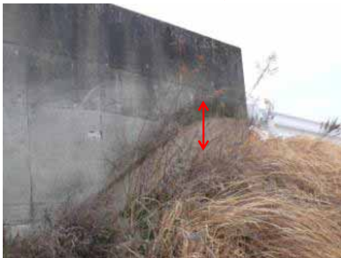
盛土と橋脚の境界部分では、盛土部分が沈下していた。この写真でその様子がよく分かるが、この変色部分は20cm程あった。
