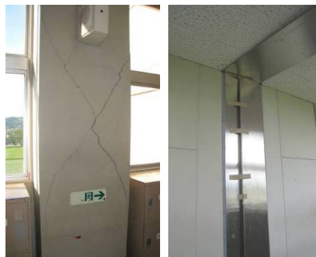
写真－3.3.9 (左) 柱のせん断ひび割れ (損傷度 III) (右) EXP. Joint カバーの損傷
