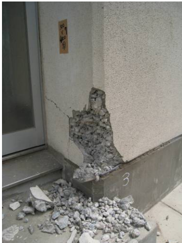
写真－3.3.11 曲げ圧壊した柱脚（ジャンカが見られる）
