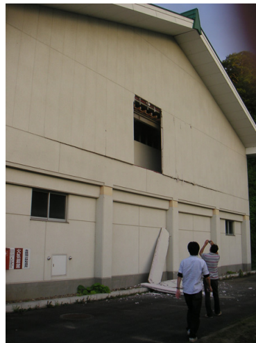
写真－3.3.3 宝来小学校屋内運動場 ALC 版の落下
