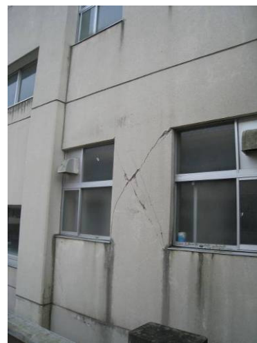
写真－3.3.12 非構造壁のせん断ひび割れ（損傷度 III）
