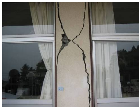
写真－3.3.5 1 階 Y0-X6 柱(損傷度 IV)
