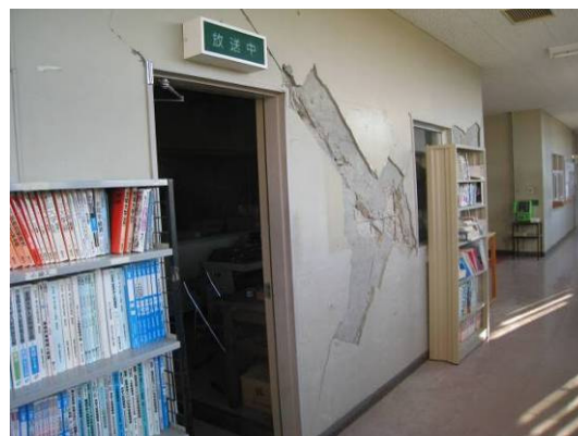
写真－3.3.10 せん断破壊した壁 (損傷度 III)
