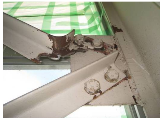
写真-3.3.7 接合部におけるブレースの破断
