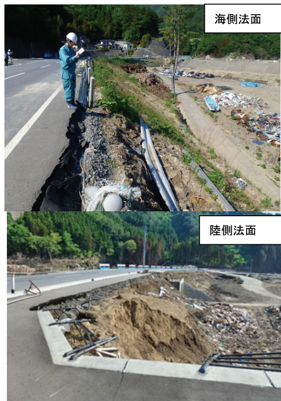
図-23 本郷地区盛土の被災状況
