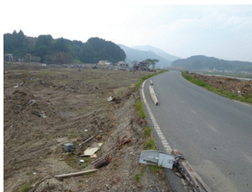
図-7 浸食されて急勾配となった堤内側法面
