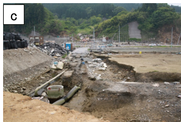
図-4 気仙大橋取り付け部での被災状況
