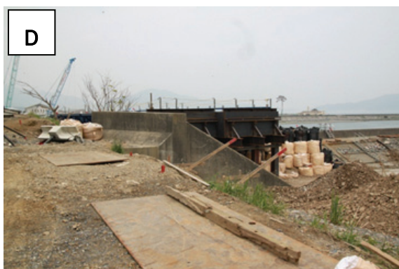
図-4 気仙大橋取り付け部での被災状況（続き）
