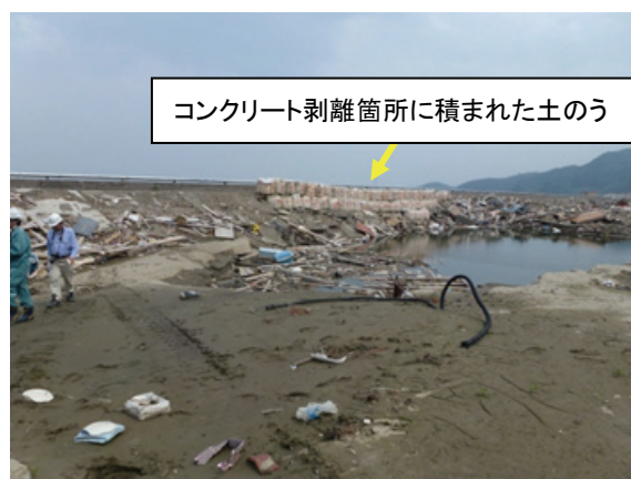
図-7 堤防の被災状況と落掘れ
