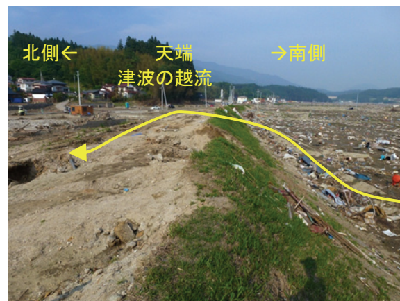
図-14 鉄道盛土（左岸側）の被災状況
