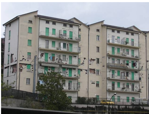
写真-67 3階、4階での被害が目立つ(5)
