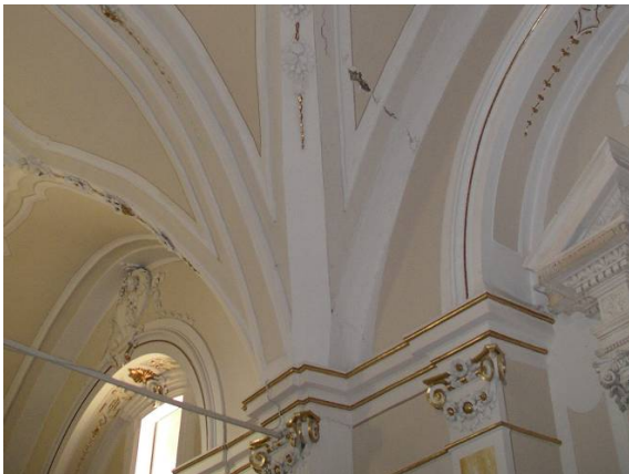
写真-129 ヴォールトのひび割れ
