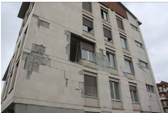
写真-59 仕上げ材の剥落(2)
