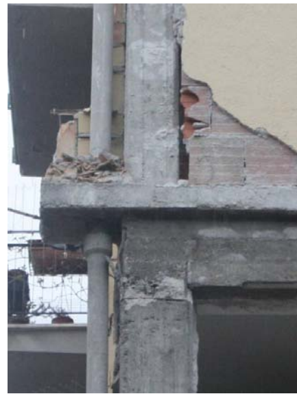
写真-66 3階と4階の柱で断面変更部分／接合部の鉄筋が露出(4)
