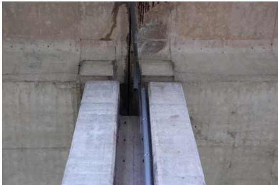
写真-153 橋軸方向への桁の残留移動
