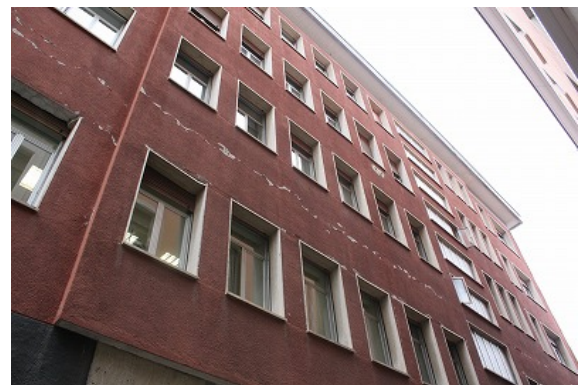
写真-38 壁のひび割れ(2,3階境界位置)(2)
