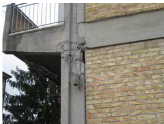
写真-100 柱頭部の接合部にひび割れ
