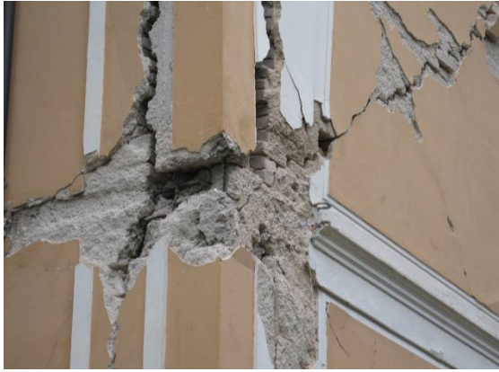
写真-63 接合部の破壊状況(3)
