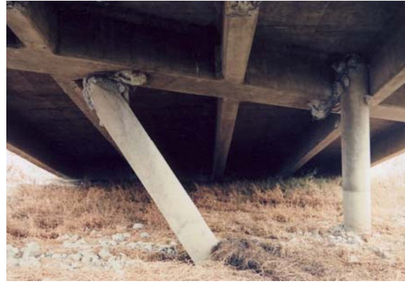
写真-140 地盤の支持力不足のため大 きく変形し、破断した桁との 固定部
