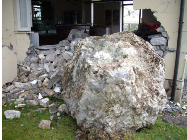
写真-7 公園最下部の建物の壁を直撃し、破壊した落石
