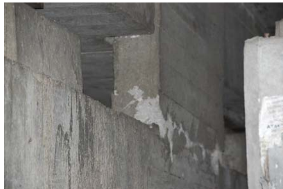
写真-157 せん断キーの損傷
