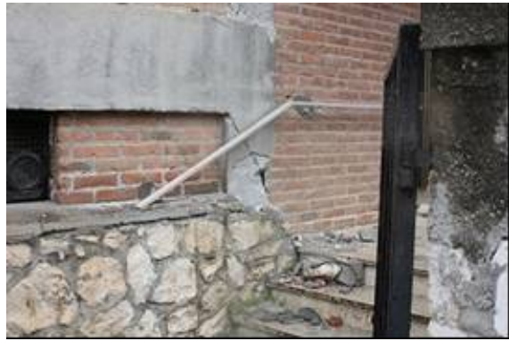
写真-102 柱脚部のせん断ひび割れ
