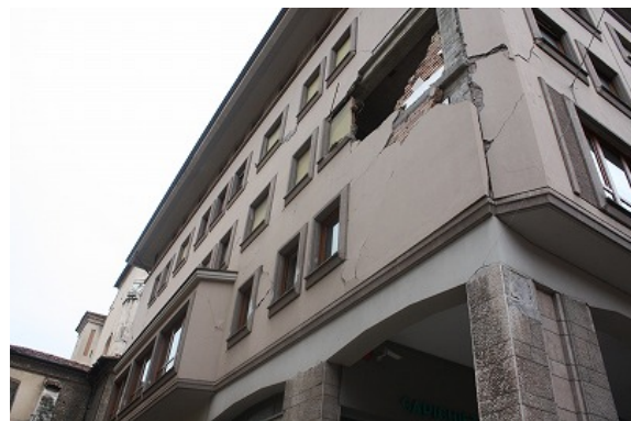
写真-46 隅角部の損傷とブロック壁の崩落(4)
