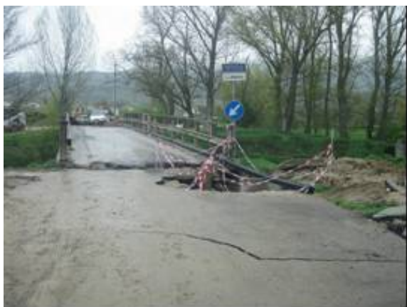
写真-83 オンナへ渡る橋の接続道路の崩落
