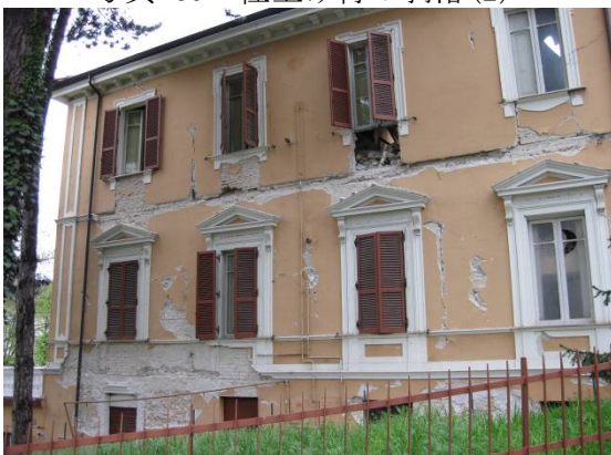
写真-61 長辺方向の損傷状況(3)
