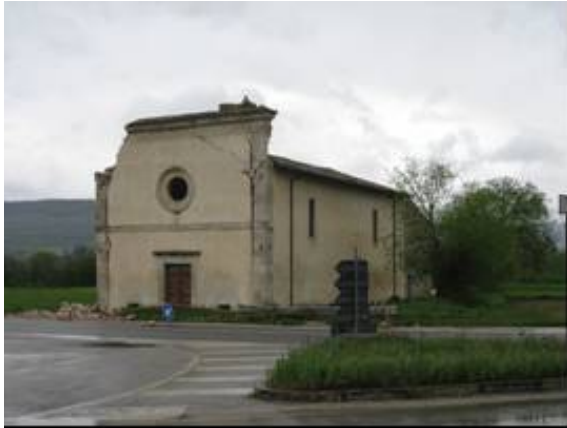
写真-77 余震による組積造教会の破損
