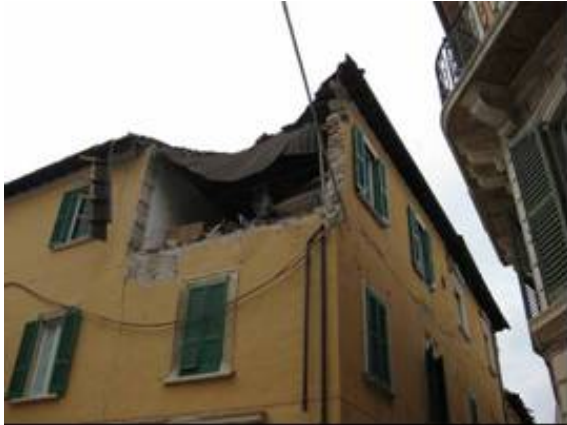
写真-31 組積造3階部分の外壁が崩落
