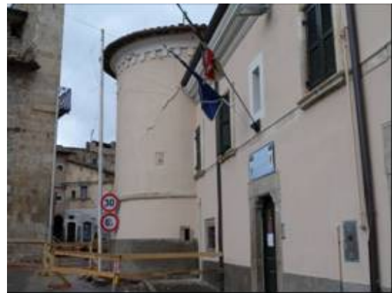
写真-90 教会前建物の円筒組積壁のひび割れ
