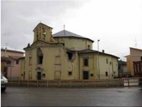
写真-89 教会の組積壁の崩落
