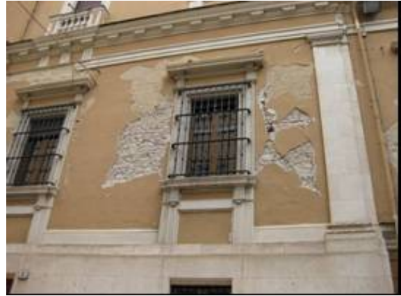
写真-26 天然石の組積壁の破壊と仕上の剥落
