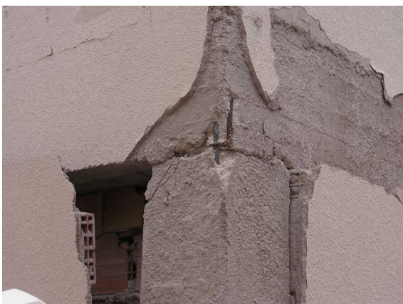
写真-111 柱頭の破壊状況
