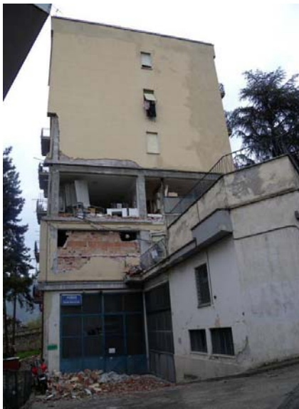
写真-65 空洞煉瓦壁の崩落／柱断面が2階、4階でしぼられている(4)
