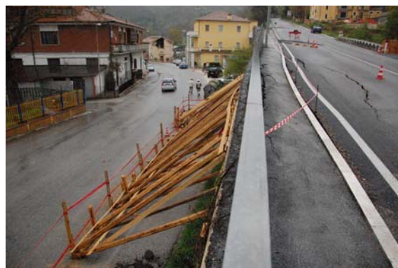
写真-159 沈下した路面
