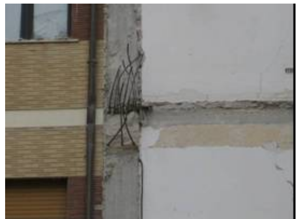
写真-72 4階連結梁主筋の露出と非連結の床
