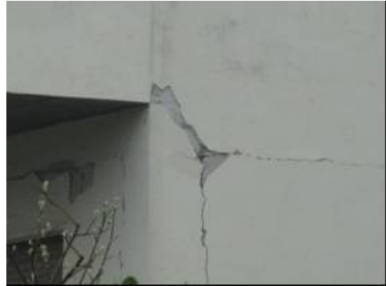
写真-92 隅柱の柱頭接合部にせん断ひび割れ
