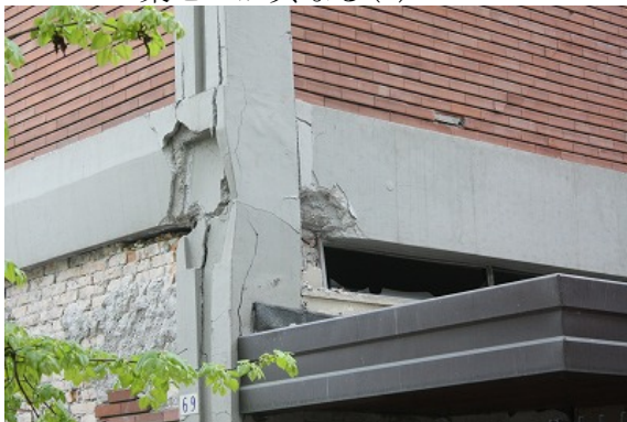
写真-51 1階ピロティ柱頭-接合部の損傷(8)
