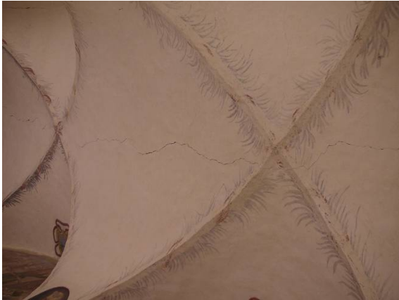
写真-127 ヴォールトのひび割れ
