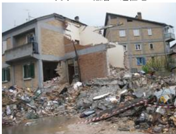
写真-98 低層RC造の崩壊
