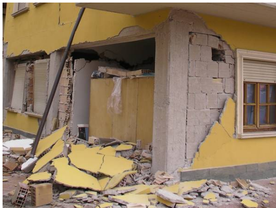
写真-117 煉瓦ブロック壁の面外崩壊
