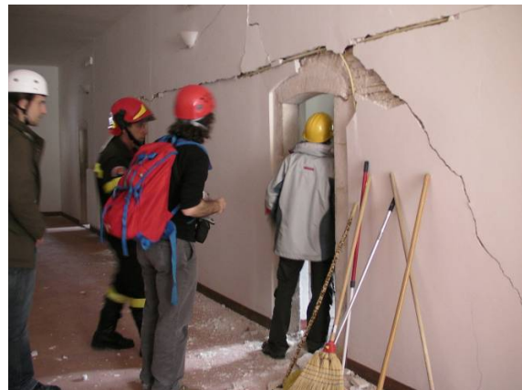
写真-124 壁のひび割れ
