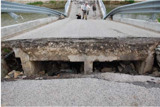
写真-131 3径間連続橋の落橋 (Fossa 駅近く)
