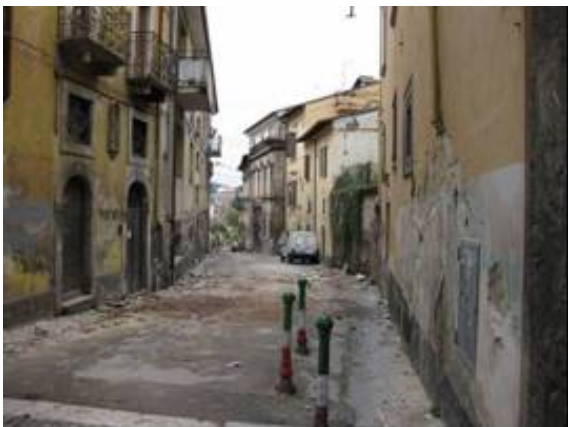
写真-29 Via Donadei 通りの仕上剥落
