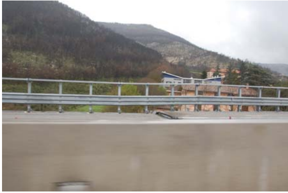
写真-151 桁端部に生じたギャップ
