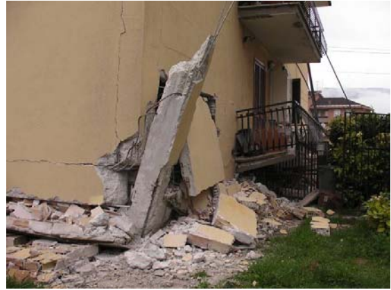
写真-114 層崩壊の様子2
