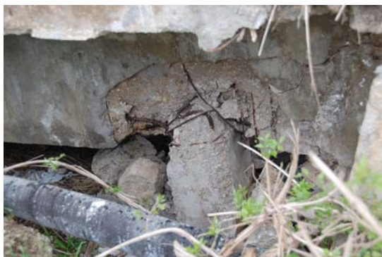
写真-137 橋台用パイルベントと主桁固定部の損傷
