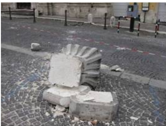
写真-21 教会の落下物
