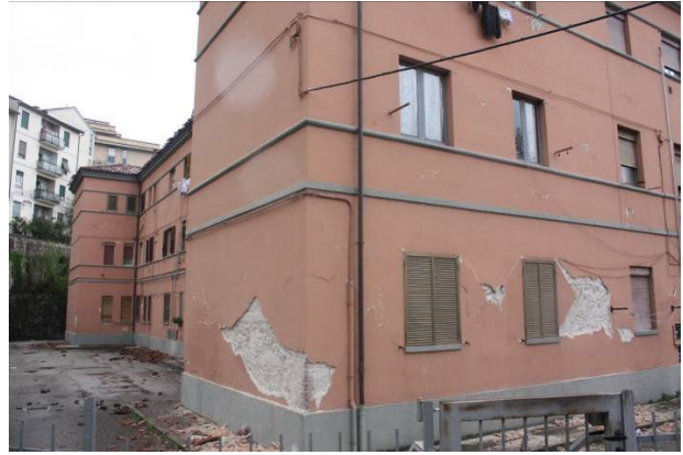
写真-64 壁の被害／柱は煉瓦、壁は石積(6)
