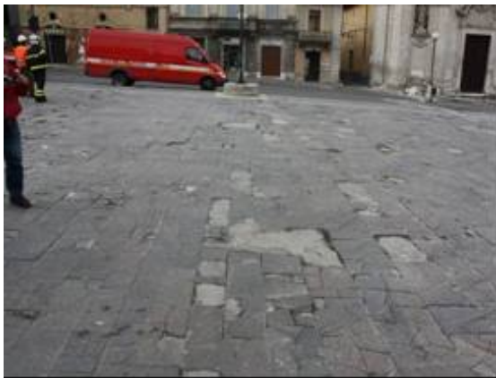
写真-17 石畳の損傷
