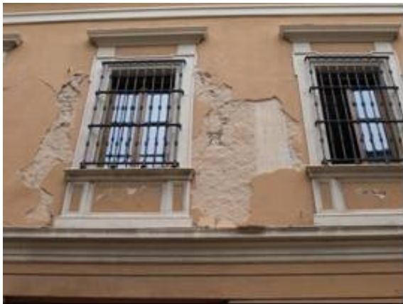
写真-27 仕上モルタルが剥離しRC柱が露出
