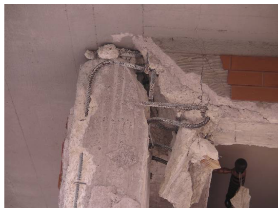
写真-112 柱梁接合部の破壊状況
