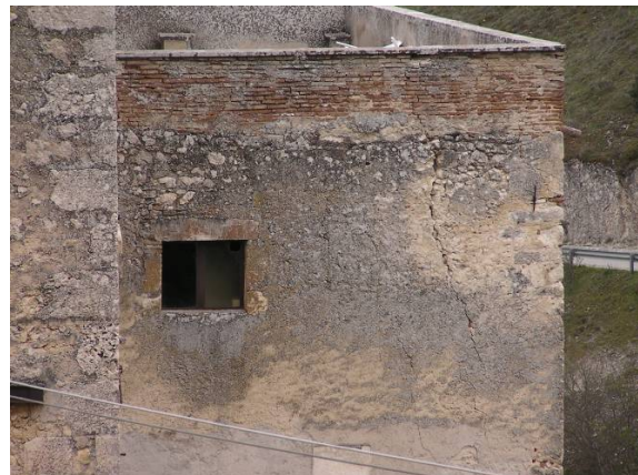
写真-126 バルコニーのひび割れ
