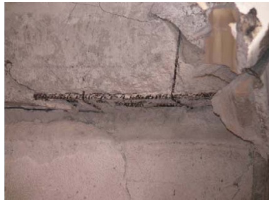
写真-116 鉄筋腐食の様子
