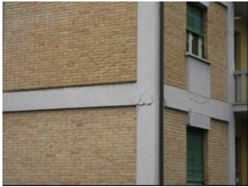
写真-101 4階建てRC住宅／接合部にひび割れ
