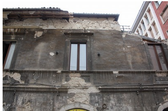
写真-42 調査区域内にあった組積造建物の被害(3)
