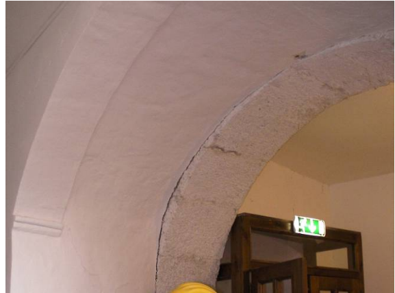
写真-128 アーチのずれ
