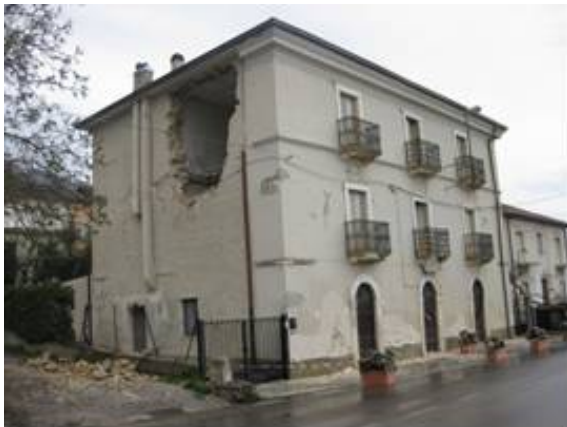
写真-79 組積造の外壁2階部分の崩落
