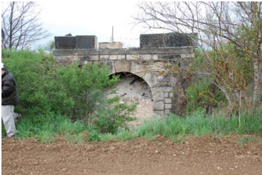
写真-144 被災し応急復旧された石造アーチカルバート
