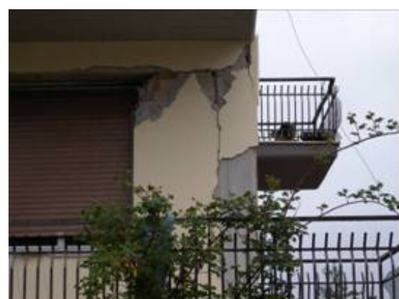
写真-94 隅柱の柱頭接合部にせん断ひび割れと付着ひび割れ
