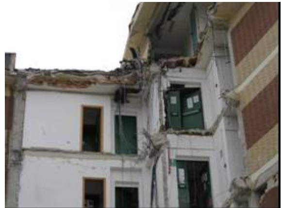
写真-70 増築部分の梁鉄筋が露出
