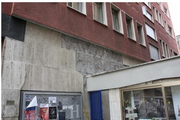
写真-37 鉄骨埋め込み部周辺の損傷(2)
