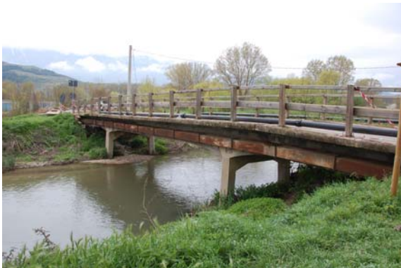
写真-141 橋台及び橋脚に被害を受けた橋 (Onna 村に通じる道路がアテルナ川を 横断する位置)
