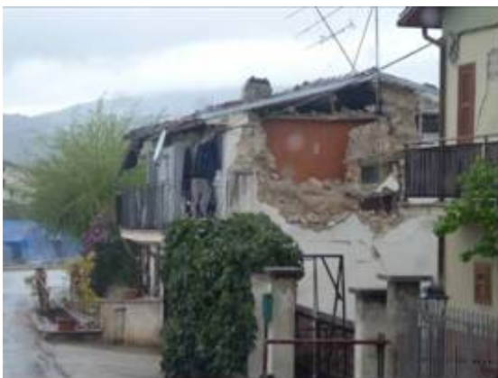
写真-93 石積+土目地壁の崩壊
