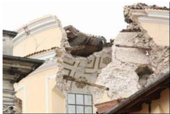
写真-20 崩壊したドーム
