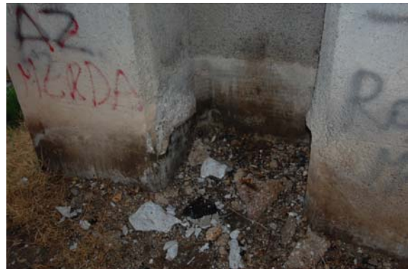
写真-156 橋脚基部のかぶりコンクリートの剥離
