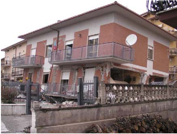
写真-113 層崩壊の様子1
