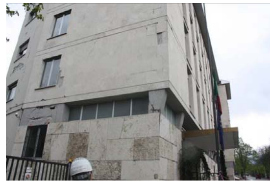
写真-60 短柱のせん断破壊(2)
