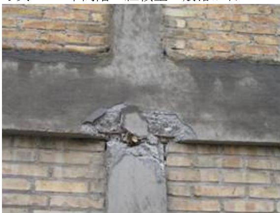
写真-97 柱頭部のひび割れ（非常に細いせん断補強筋）
