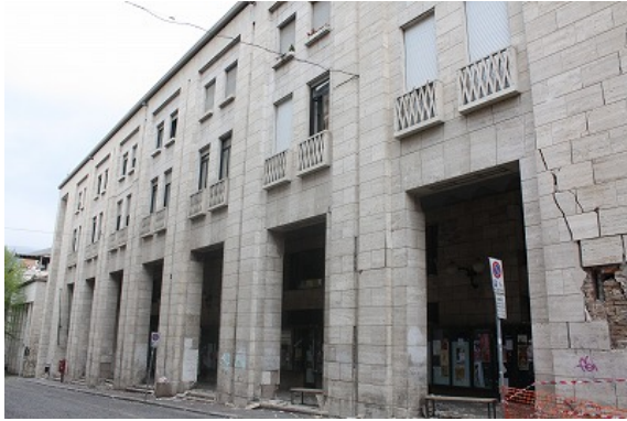
写真-47 柱のふかし部の損傷と 柱脚タイルの剥落(5)
