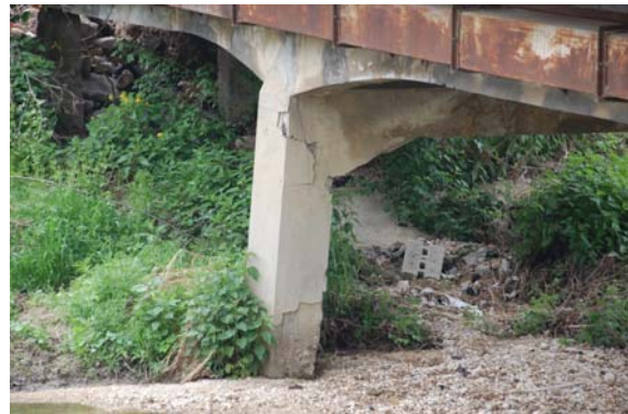
写真-142 RC ラーメン橋脚の損傷
