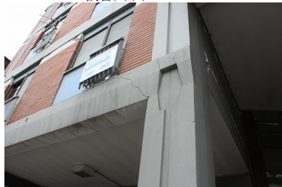
写真-52 2階床梁のせん断ひび割れ(8)
