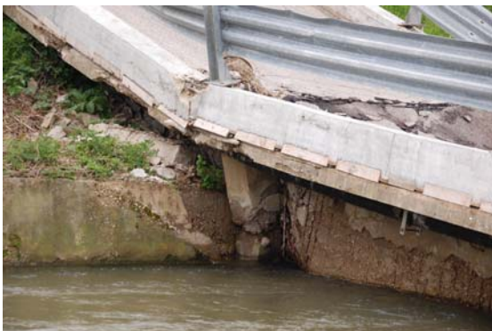
写真-133 パイルベント橋脚の損傷
