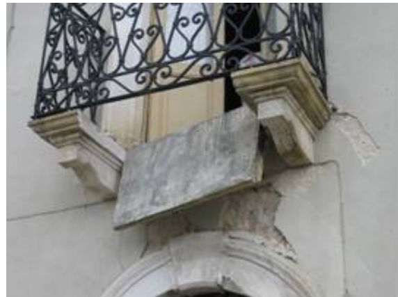
写真-80 バルコニーの石が割れている
