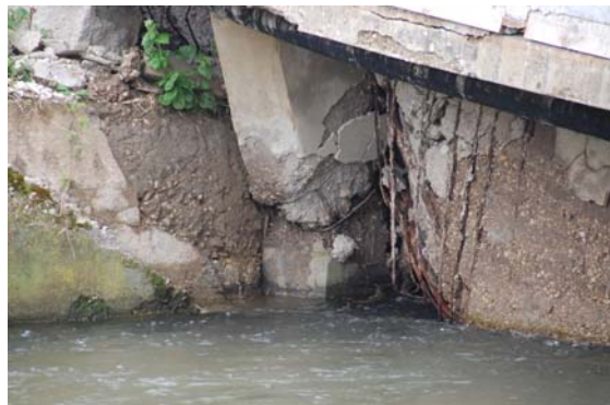
写真-136 パイルベント橋脚の損傷
