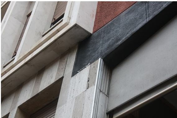
写真-41 梁のせん断ひび割れ(2)
