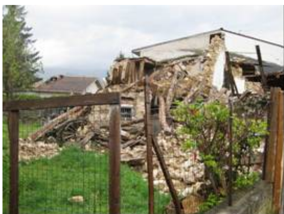
写真-87 組積造の崩壊
