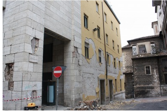
写真-48 建物側面の仕上げ部の剥落(5)
