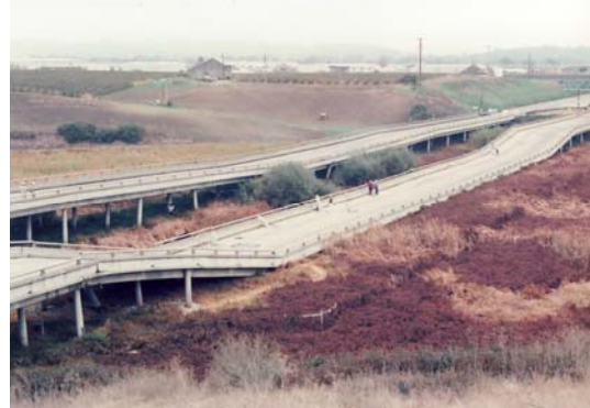
写真-138 ストラブスルー橋の被害 (1989年ロマプリータ地震)
