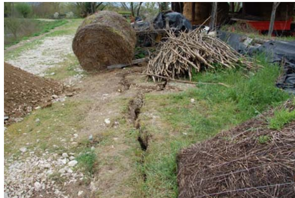
写真-2 Aterno 川堤体に生じたクラック
