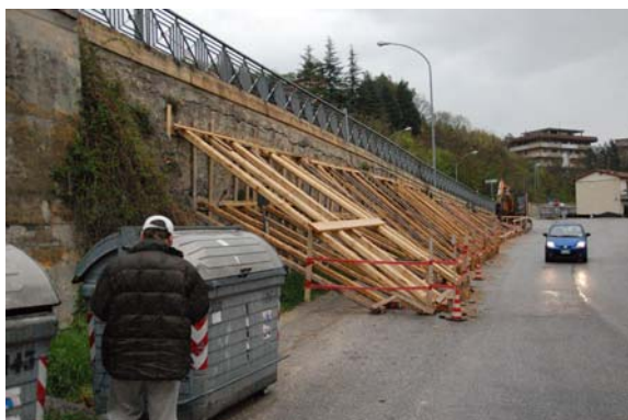
写真-159 盛土の変形とこれに対する応急復旧
