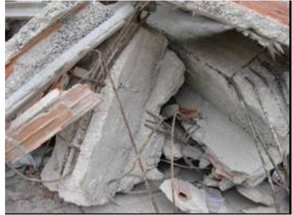
写真-74 寮崩壊付近のRC部材の残骸
