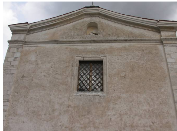
写真-130 ファサードのひび割れ
