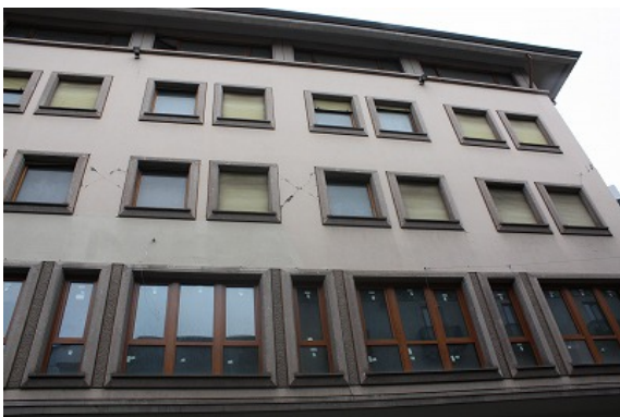
写真-45 柱のせん断ひび割れ(4)
