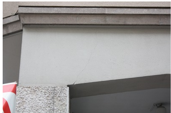
写真-44 梁のひび割れ(曲げひび割れ)(4)
