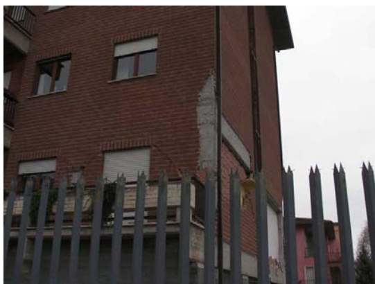
写真-119 開口部間のせん断ひび割れ
