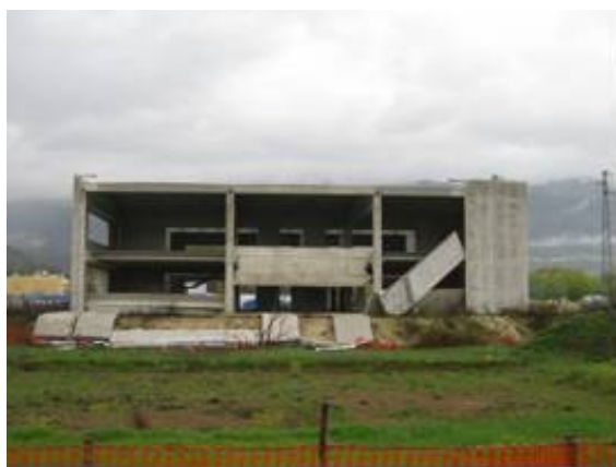
写真-85 建設中のPCa造工場の被害
