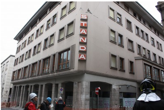
写真-43 隅角部の柱の損傷と壁のひび割れ(4)
