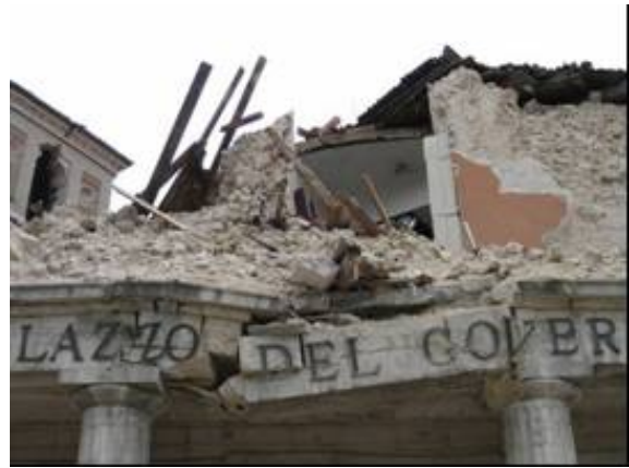
写真-34 組積造PLAZZO DEL GOVERNOの 崩壊
