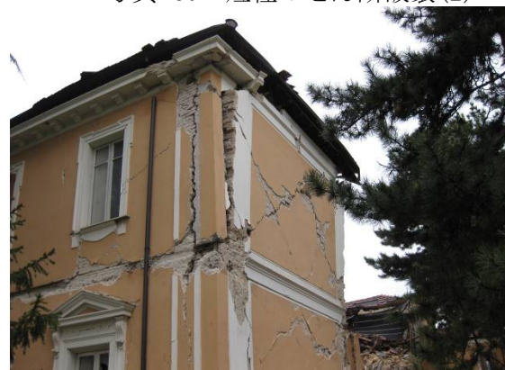
写真-62 壁が面外方向に傾斜(3)
