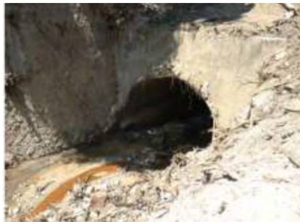
写真2.3-1 道路横断管の閉塞状況 4)
