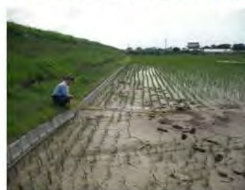
R7 右岸 11.8k 被災 (漏水)
