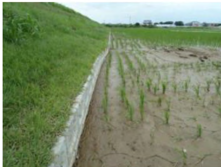
7月16日 堤内地 漏水状況①
