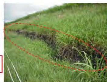
R7 右岸 11.8k 被災 (亀裂・陥没)
