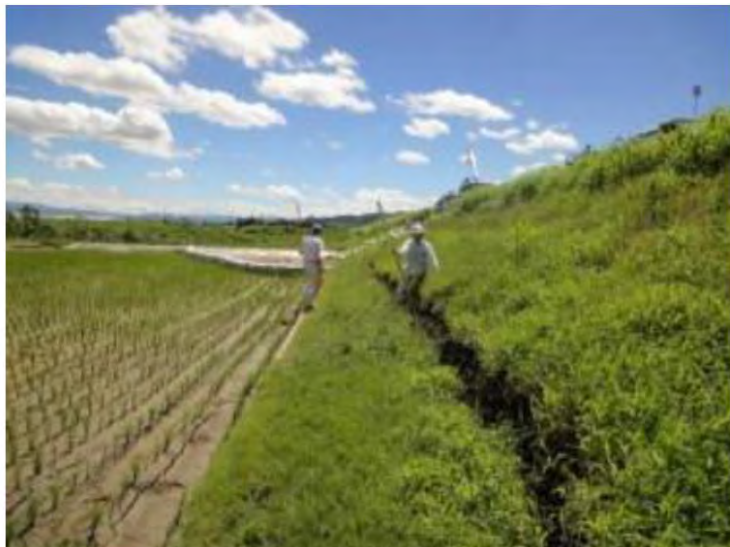
7月16日 のり尻陥没状況
