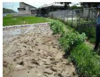
L6 左岸 16.0k 被災 (漏水)
