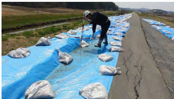
天端川表 側に開口 亀裂発生
