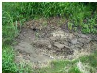
R2 右岸 6.0k 被災 (漏水)
