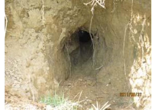
浸透破壊を起こした穴
