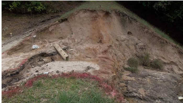
越流によるため池の破堤断面 向迫田ため池(山県郡北広島町) (平成30年7月豪雨)
