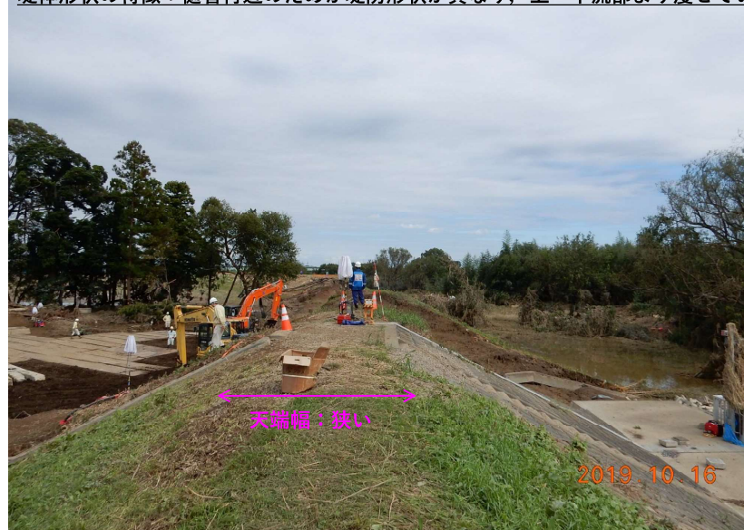
写真③：都幾川右岸0.4k付近（小剣樋管） 下流側より ー 堤防決壊・応急復旧状況ー 堤体形状の特徴：樋管付近のためか堤防形状が異なり，上・下流部より痩せている
