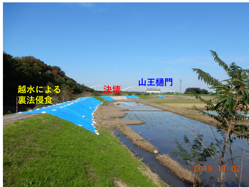
新江川右岸，山王樋門から120m：越水による決壊状況
