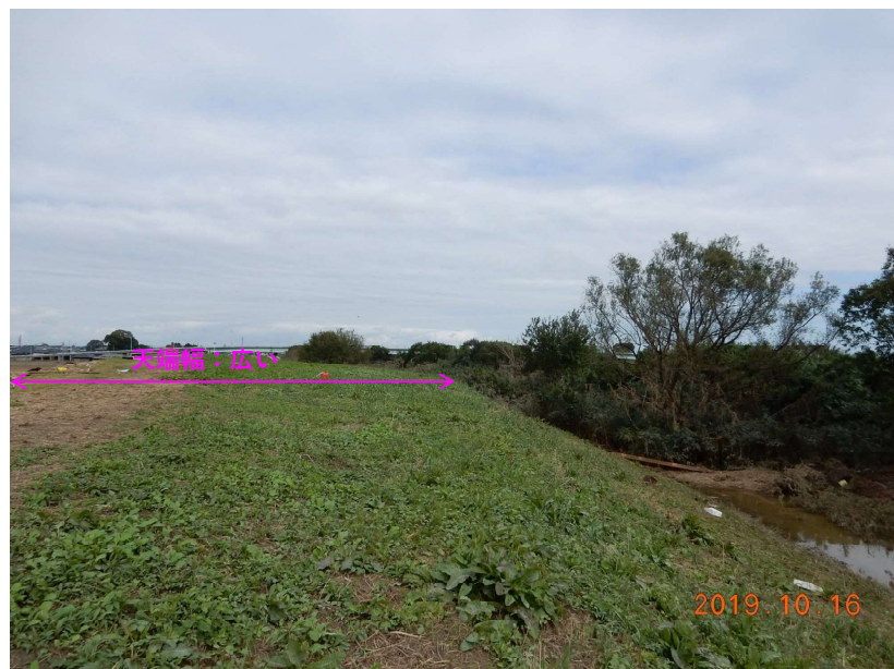
写真③：都幾川右岸0.5k付近（小剣神社） ー 決壊した堤防より上流側の堤防の状況ー
