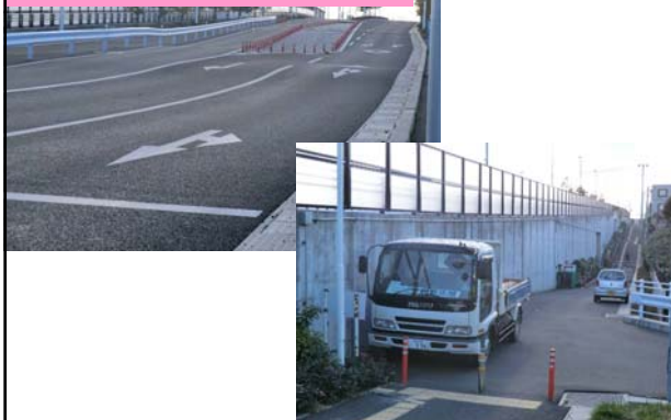
6-6.新設道路擁壁裏込め土の 不同沈下(地中構造物周辺?)
