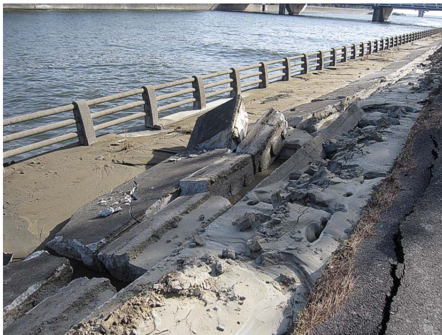
噴砂，液状化により流動の痕跡あり
