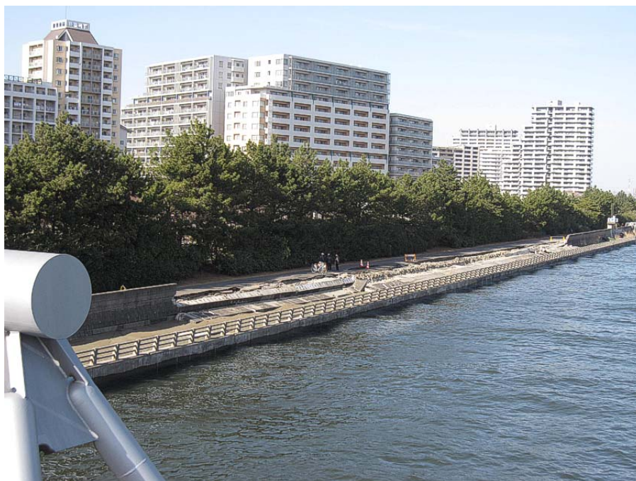
花見川右岸の防潮堤の倒壊箇所の全景
