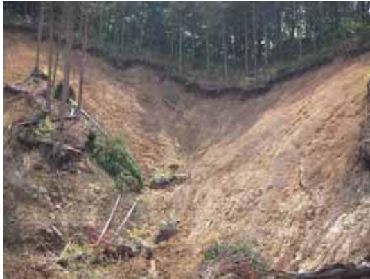
大戸川支溪 源頭部の一部 基盤岩が露出 深さ1m程度であるが、崩壊幅は広い
