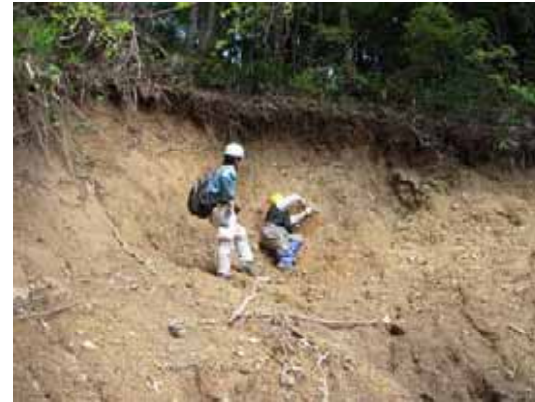
滑落崖の状況、崩壊深さ約1.5m 滑落崖には土砂(礫混じり砂質シルト)が露出
