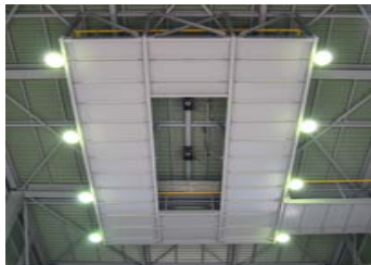
撮影建屋内部のカメラ配置
