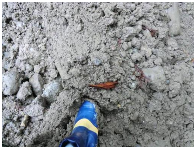
口絵写真-3 崩壊した盛土の末端部が泥濘化した状況(仙山線, 作並～八ツ森間)
