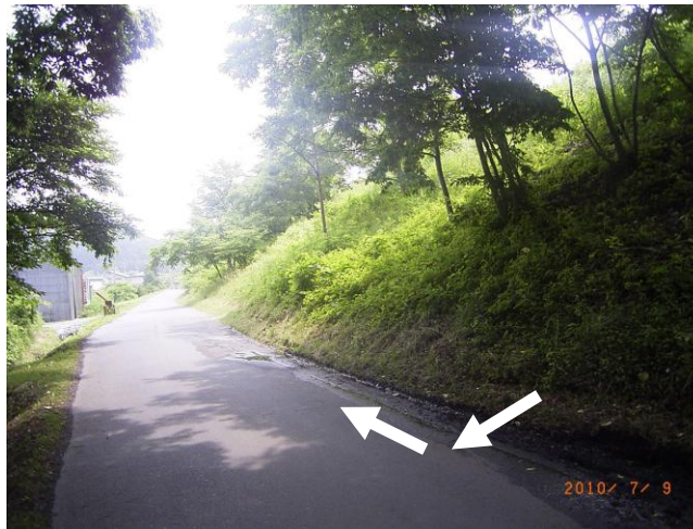
口絵写真-1 盛土法尻部のふとん籠からの湧水と縦断方向への流下状況(青い森鉄道, 八戸貨物～陸奥市川間)
