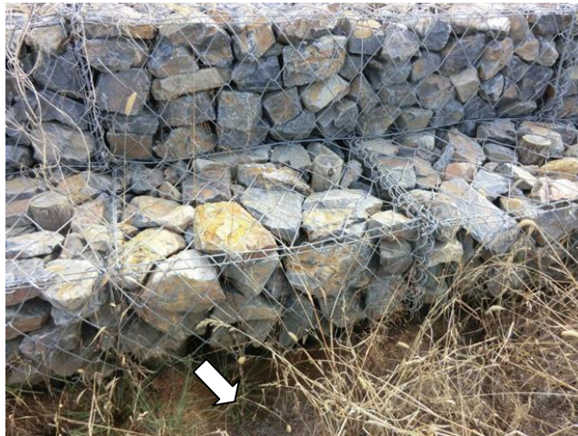
口絵写真-2 盛土法尻部のふとん籠からの湧水状況(東北線, 泉崎～矢吹間)
