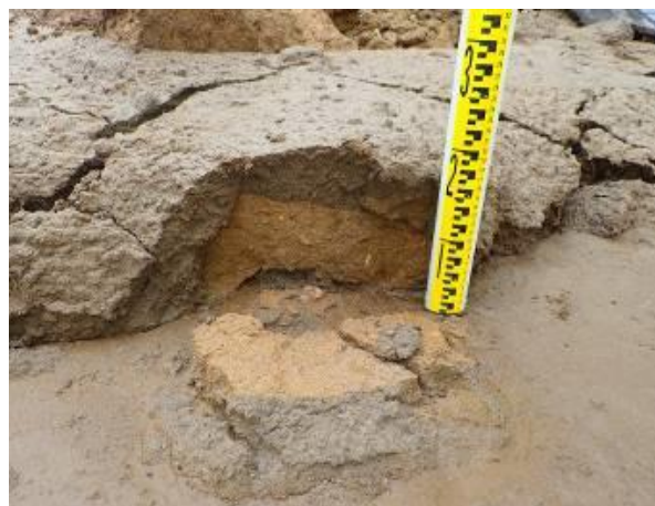
図 3.3 舗装面上の堆積物の状況
