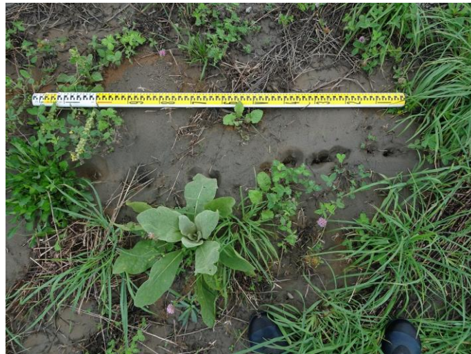
図 5.2f) 堤外地盤での噴砂 (KP2.5 付近)
